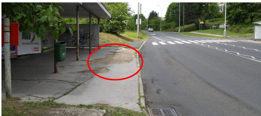
Obr. 8: Nerovný povrch nástupiště zastávky
