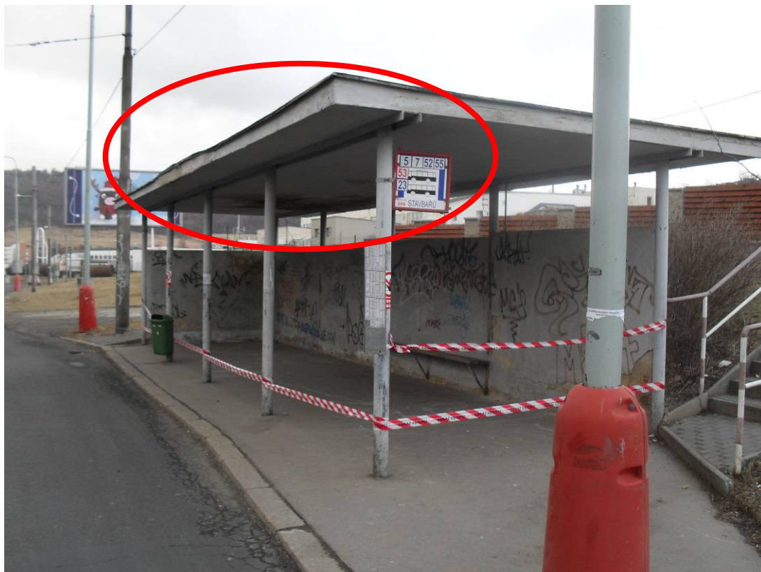
Obr. 11: Přístřešek uzavřený pro špatný technický stav
