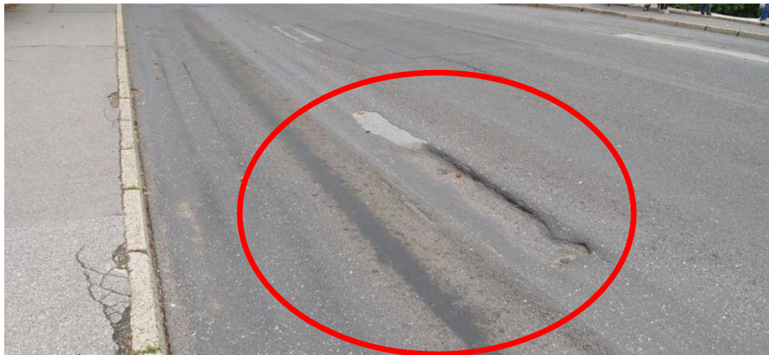
Obr. 10: Nevyhovující kryt v zastávkovém zálivu, tzv. „vyjeté koleje“
