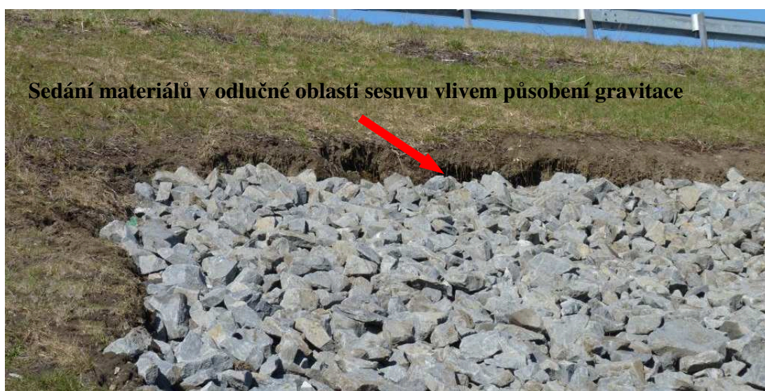
Obrázek 15: Sanace sesuvu svahu zářezu, sedání materiálů v odlučné oblasti sesuvu vlivem působení gravitace, vlastní foto pořízeno dne 16.4.2013
