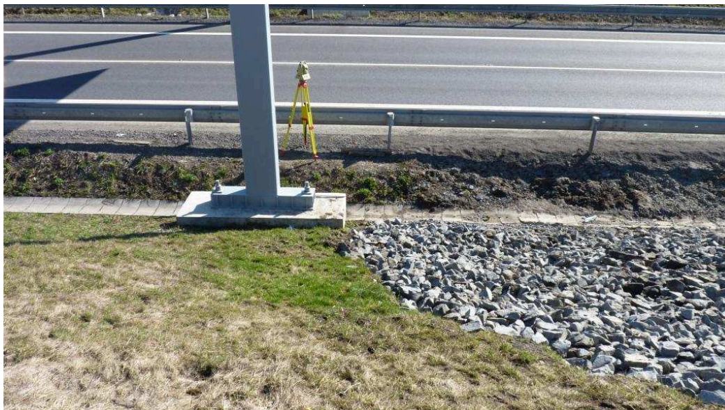
Obrázek 13: Sanace sesuvu svahu zářezu, možný přítok vody v patě svahu, vlastní foto pořízeno dne 16.4.2013
