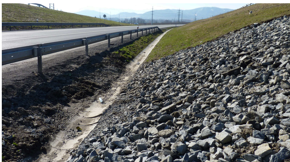
Obrázek 14: Sanace sesuvu svahu zářezu, nedokonalé očištění odvodňovacích žlabů a krajnice silnice I/58 od sesutého materiálu, vlastní foto pořízeno dne 16.4.2013
