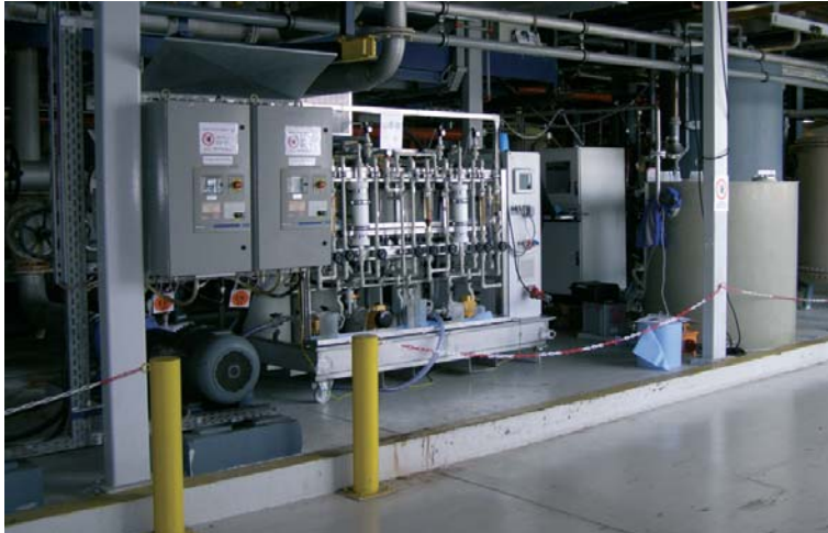
Bild 5: Anbindung der Membrankontaktoranlage an die Phosphatierlinie während der Betriebsversuche (Quelle: BFI, R. Wolters)
