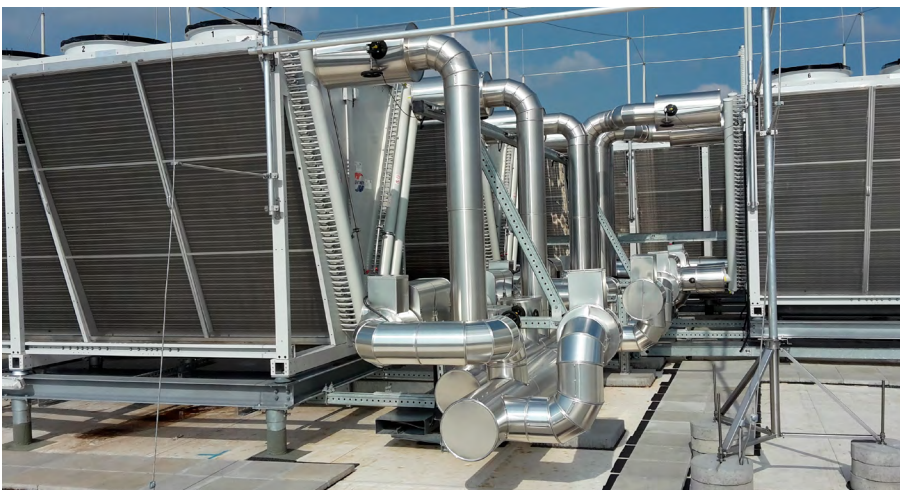
Bild 6: Rückkühler auf dem Dach des RZ-Gebäudes
