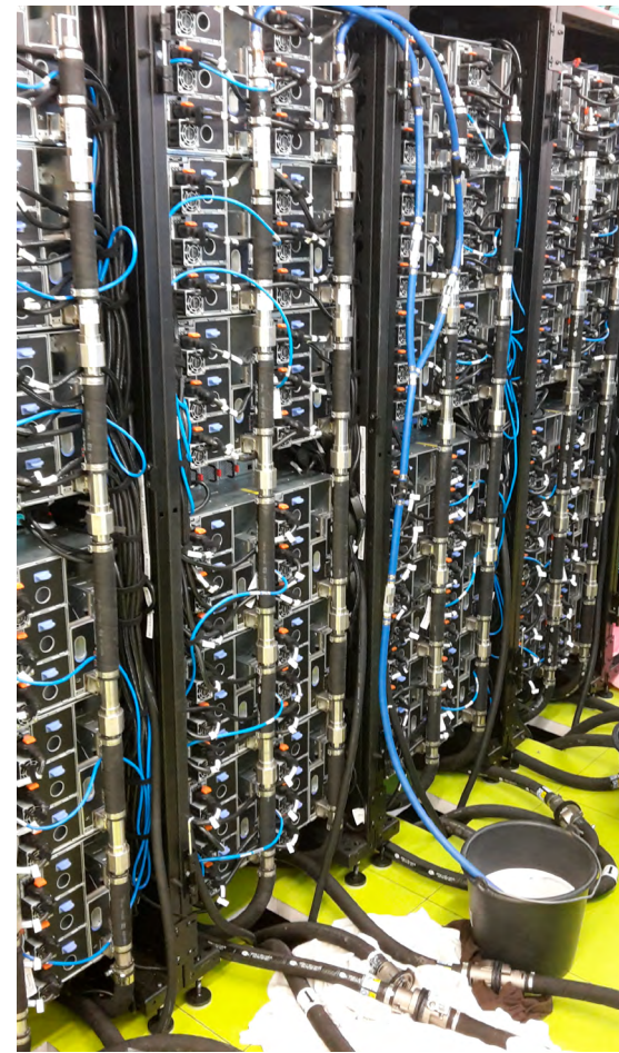
Bild 5: Entlüftung der Wasserkühlung an den Rechenknoten
