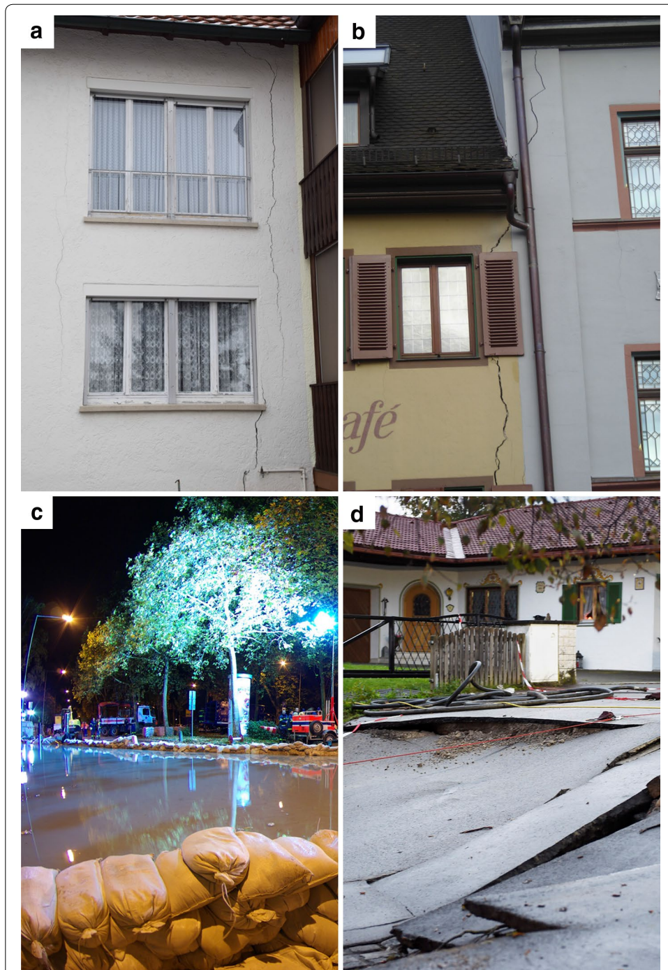
Fig. 3 Damages in Böblingen (a), Staufen (b), Wiesbaden (c), and Rottach-Egern (d). ©: a Paul Fleuchaus, b Christoph Butscher, c Michael Ehresmann, and d Thomas Plettenberg
