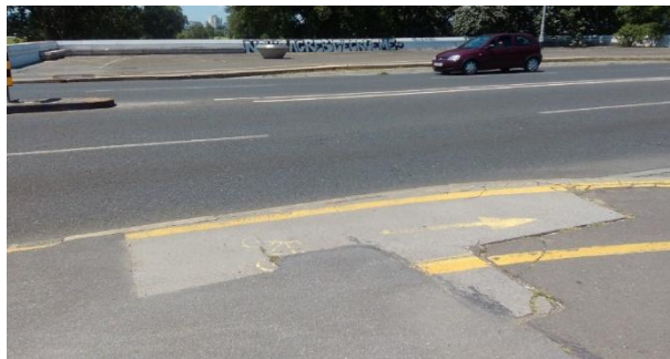
Slika 11. Prikaz oštećene i nepravilno odvojene biciklističke staze od ruba kolnika na Mostu Slobode
