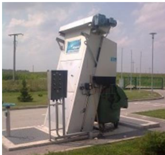
Slika 6. Automatska gruba rešetka [11]
