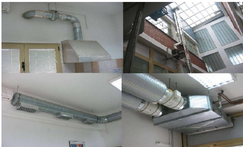
Slika 8. Odsisnana (lijevo, gore), kanali za odvod otpadnog zraka (gore, desno), kanalni razvod svježeg zraka (dolje, lijevo) i toplovodni zagrijač (dolje, desno) u laboratoriju u zgradi Geotehničkog fakulteta u Varaždinu [6]
