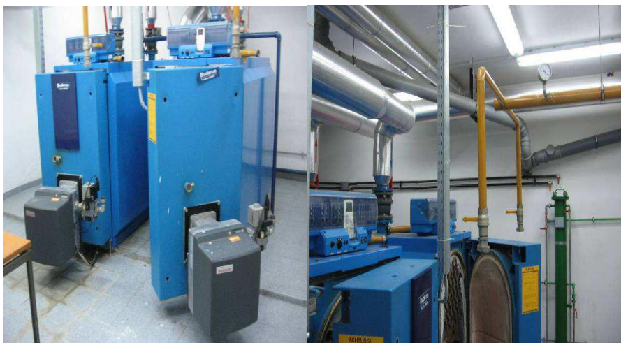
Slika 7 Toplovodni kotlovi (lijevo), dovod plina i kotlovska automatika (desno) u kotlovnici zgrade Geotehničkog fakulteta u Varaždinu [6]
