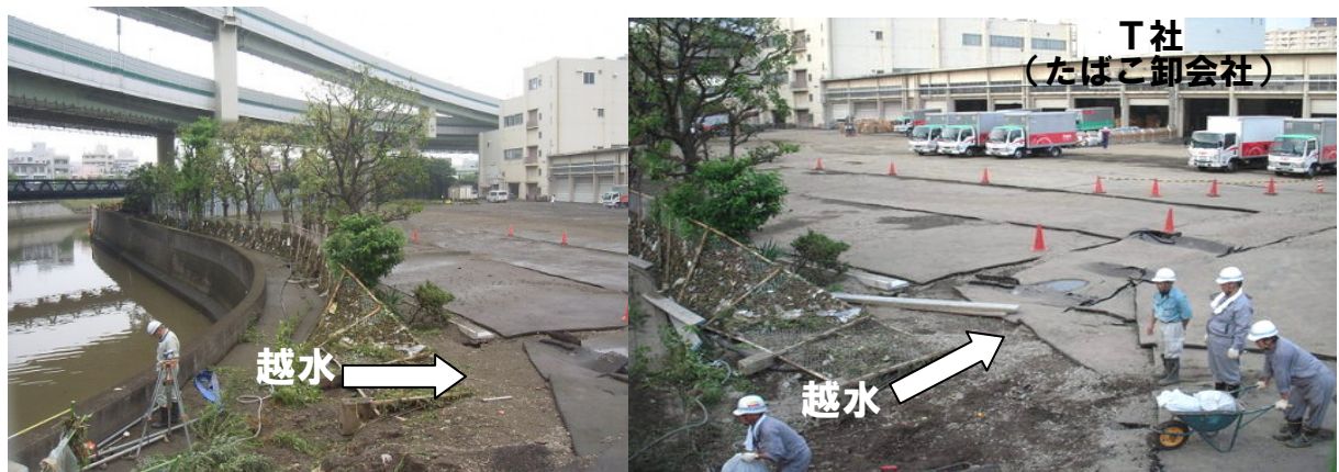
図 3-54 2010年7月洪水 越水箇所の被害写真
