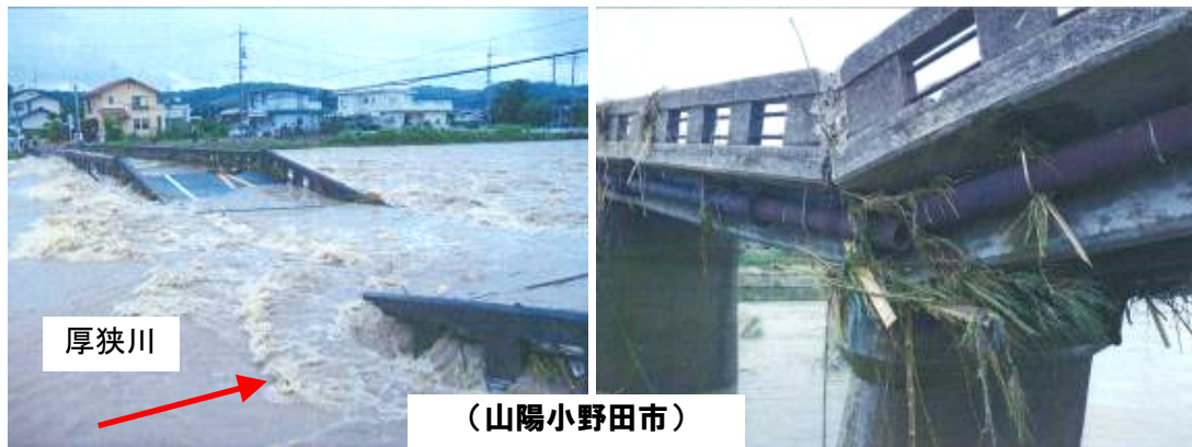
図 4-3 洪水により送水管が破断した状況
