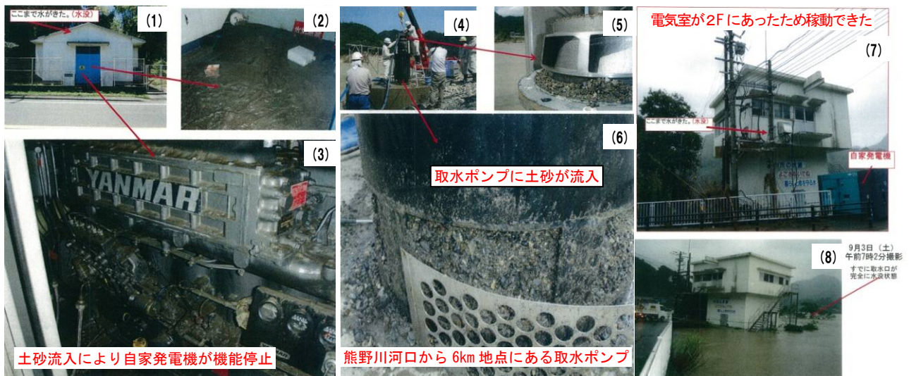
図 4-16 熊野川に面した取水施設の被災状況（新宮市）
