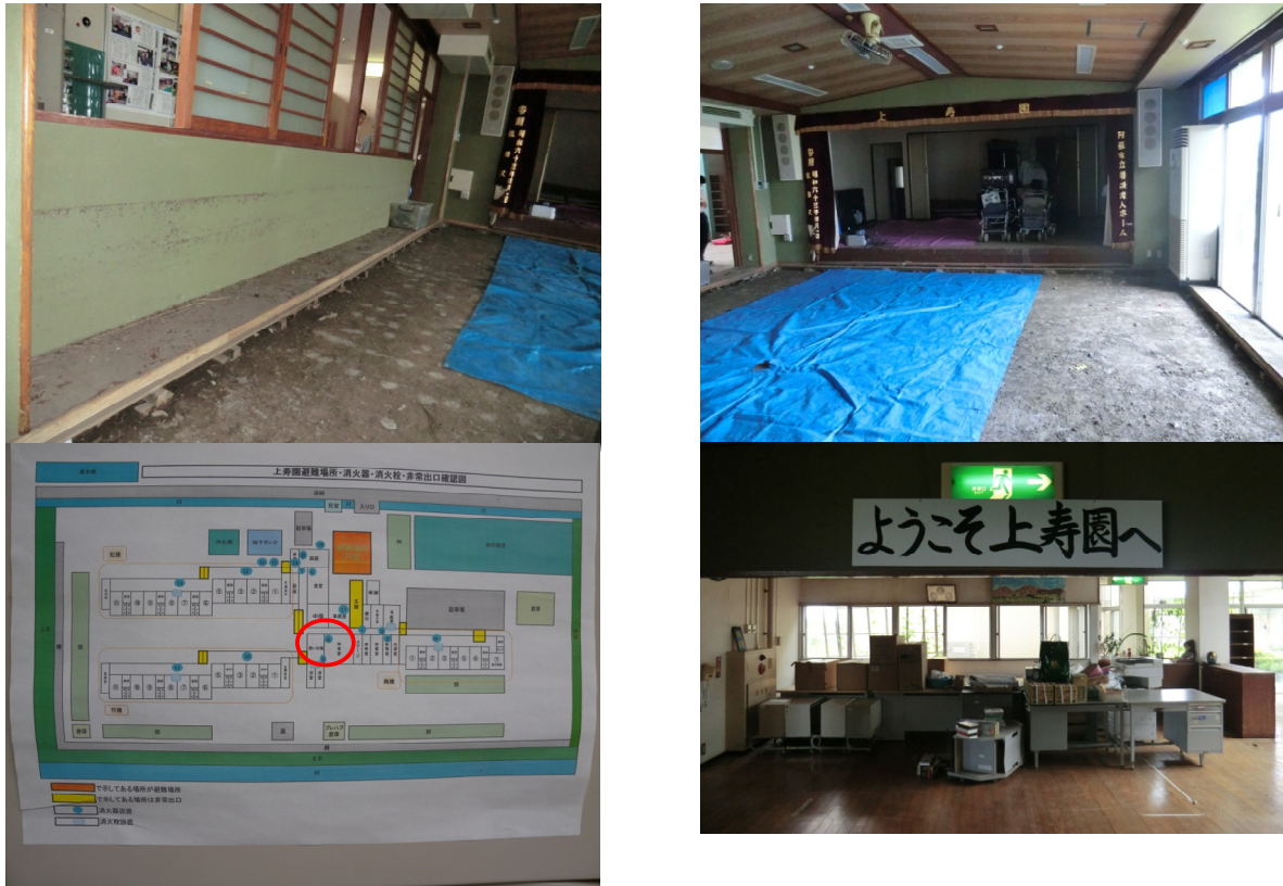
図 3-44 被災した養護老人ホーム（2）
