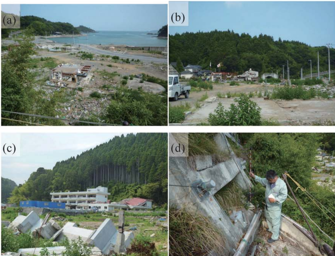
Fig. A182. (a)-(c) Damage at Aikawa. (d) Tsunami trace survey point on a slope (M39).
