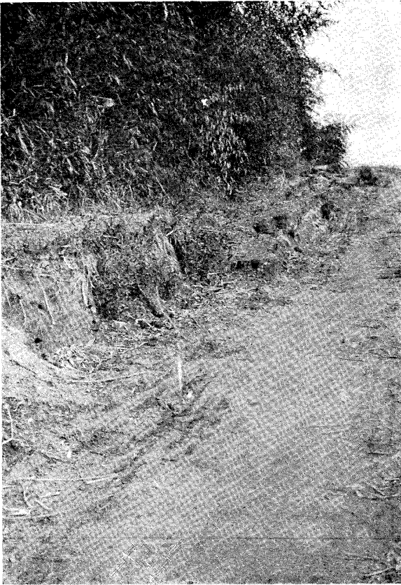
第二十 笛吹川筋東八代郡下曾根村地先堤防ノ被害
