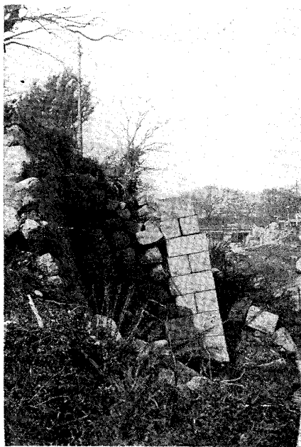
第三十四 中央氣象臺裏外濠石垣西方突角部ノ被害
