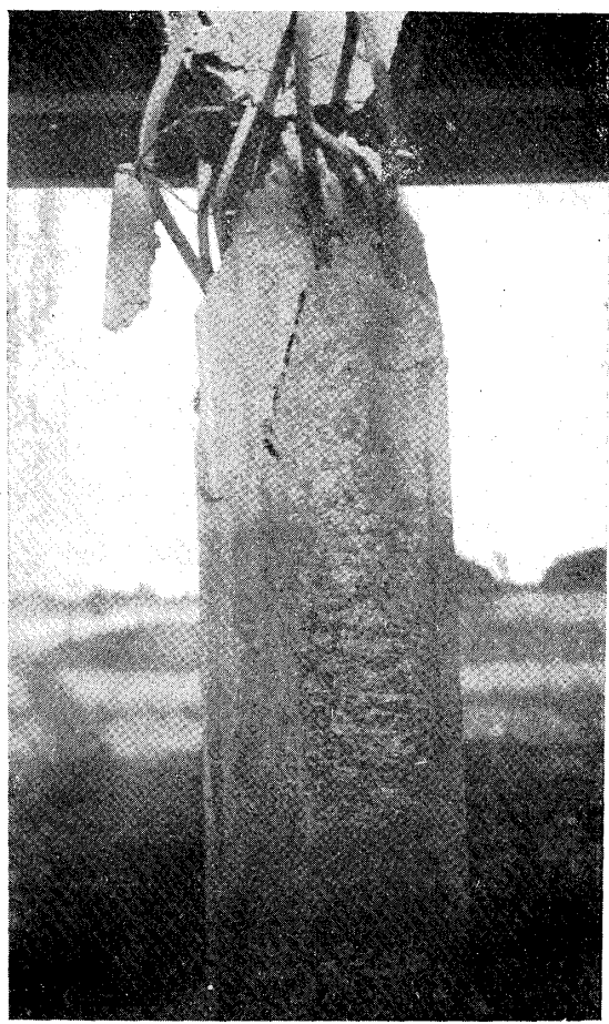
第七十一 高幡橋第五橋脚ノ震害
