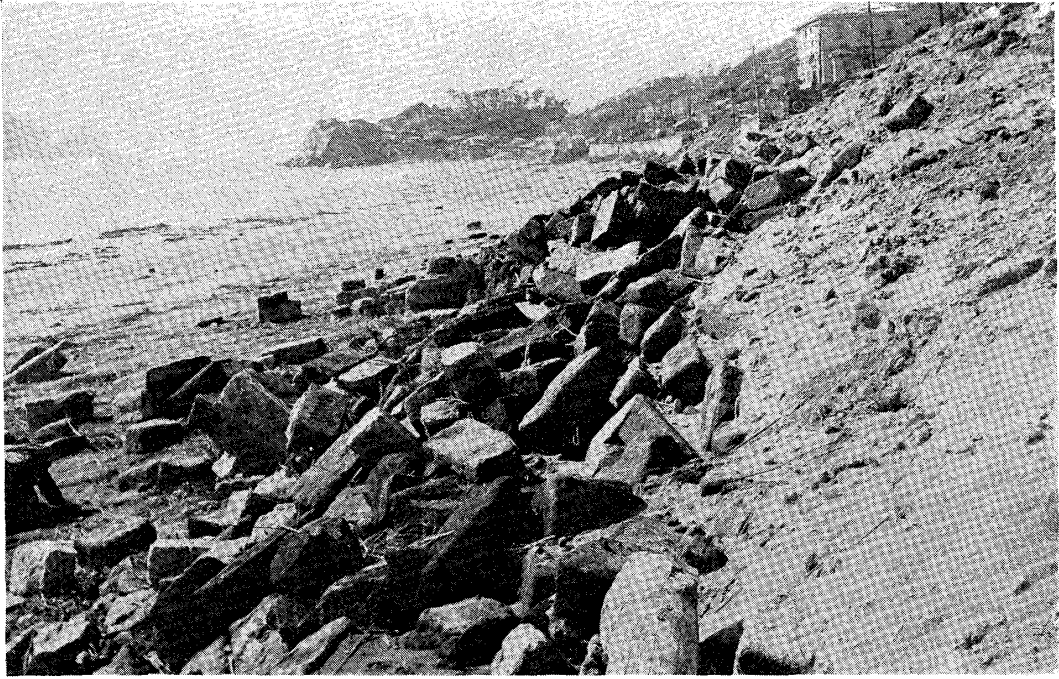
第百六 鎌倉七里ヶ濱海岸護岸ノ震害
