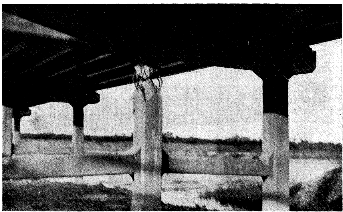
第七十二 高幡橋第五橋脚ノ震害
