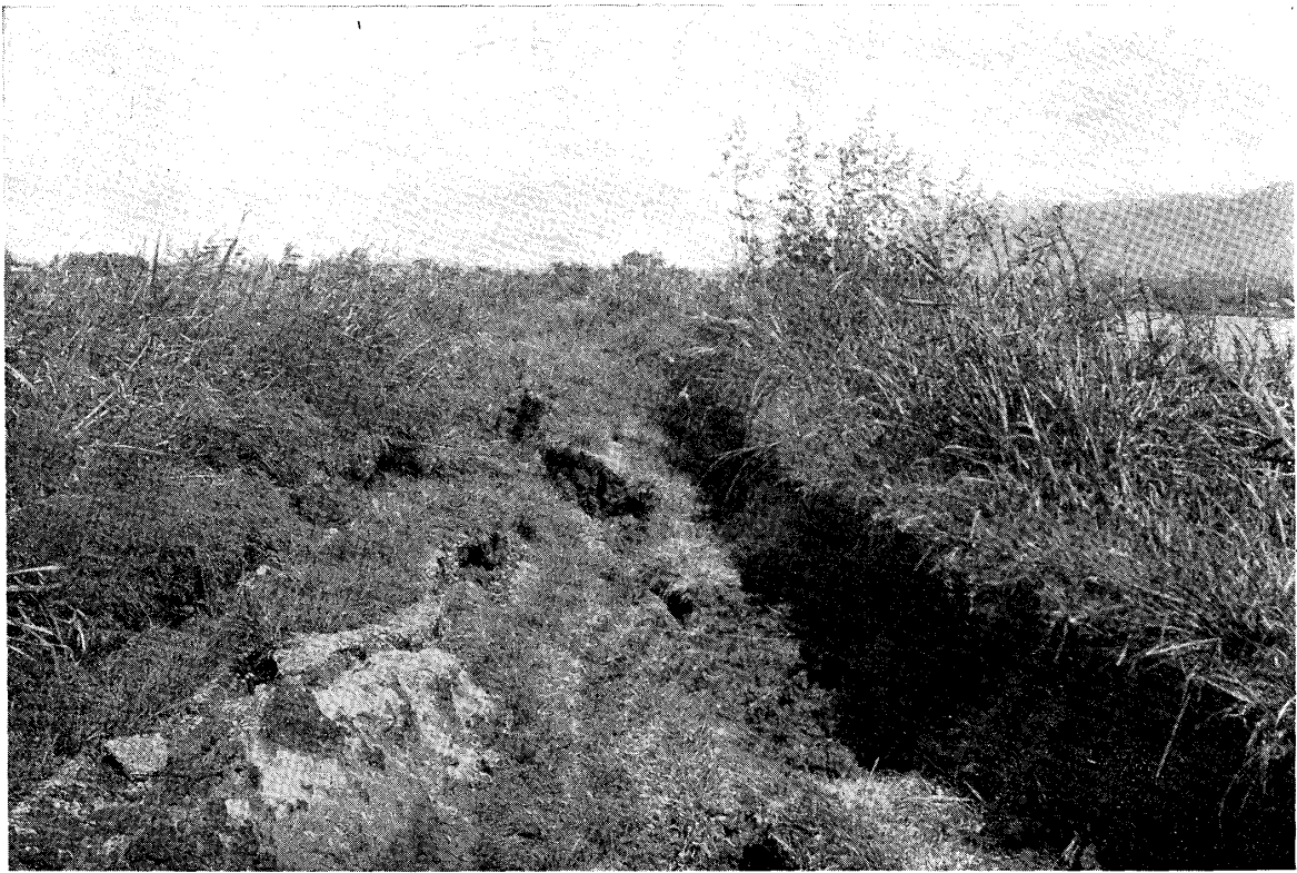
第十二第一 笛吹川筋富士見村地先堤防ノ被害
