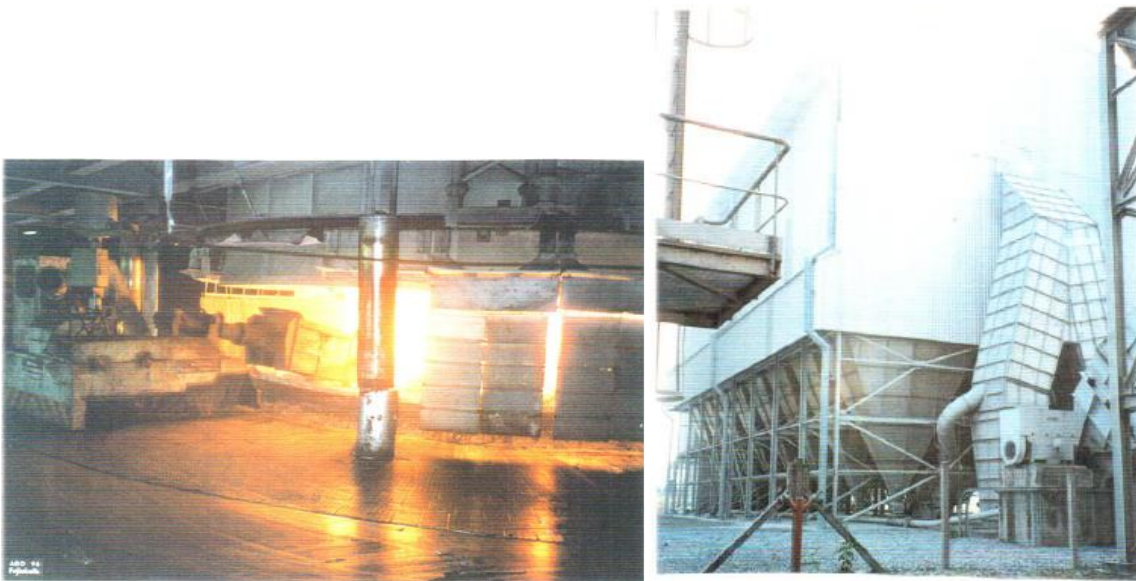
Figura 2-7: Forno elétrico giratório para fabricação do silício metálico (à esquerda) e Filtro de mangas e silos onde é coletada e armazenada a sílica ativa (à direita). (SILVA, 1997)
