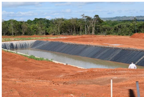
Figura 4.26 - Tanque de pré-tratamento de chorume do ASO.
