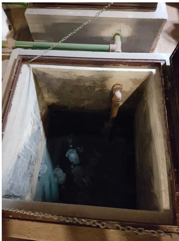
Figura 6.11 Reservatório predial cheio.
