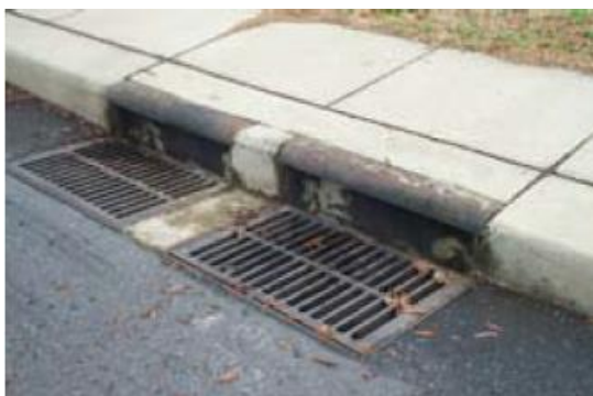
Figura 3.4 Boca de lobo dupla com grelha (Fonte: Photo Book of Storm Water Features, 2006).
