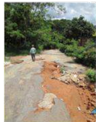
Foto 10 - erosão em ruas da vizinhança por falta de drenagem
