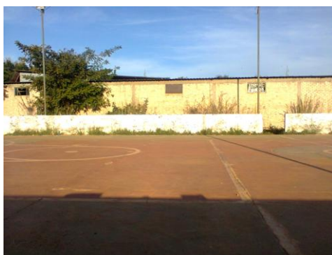
Figura.1 . Quadra sem cobertura e marcação deteriorada.
