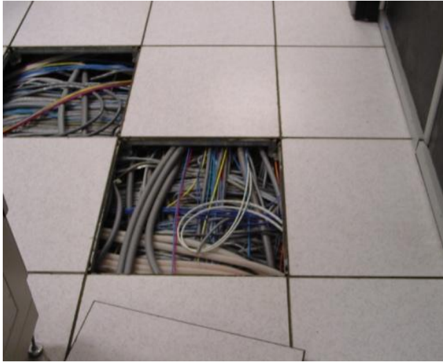
Figura 10: Piso elevado congestionado por cabos (Furukawa, 2008).
