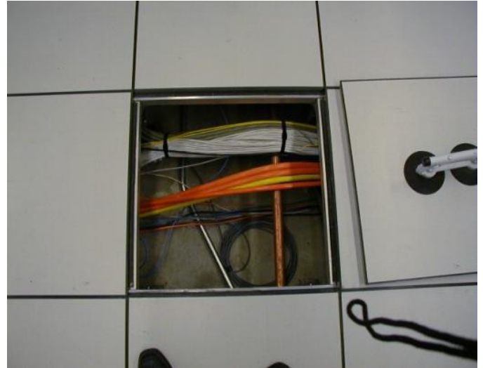
Figura 11: Piso elevado com os cabos organizados de maneira correta (Furukawa, 2008).
