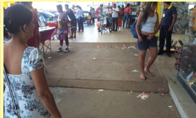
Excesso de desníveis
