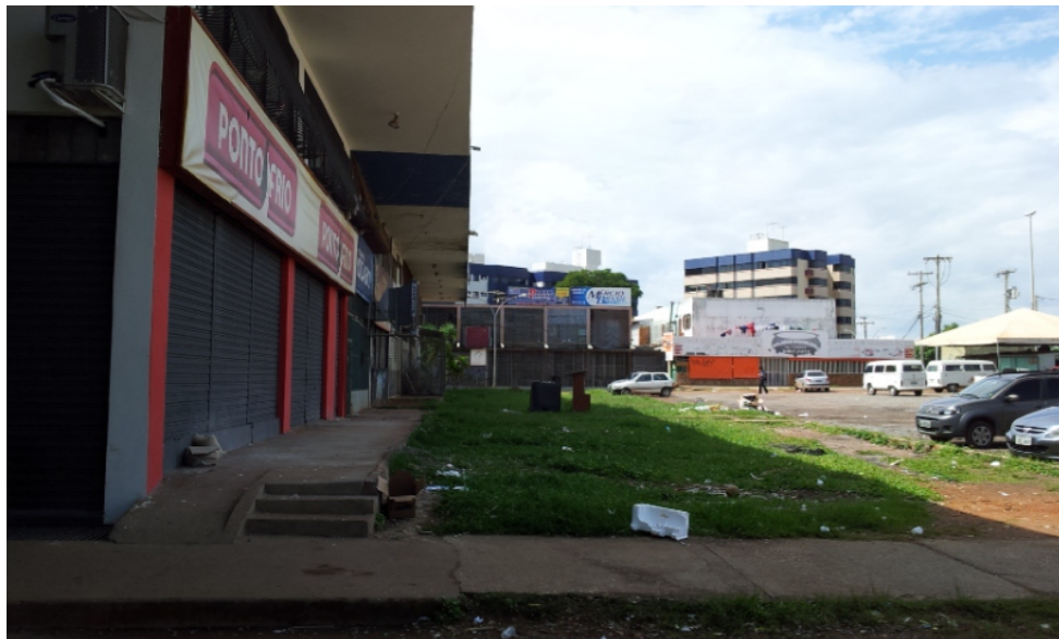
Figura 25: Estado de conservação em edifício particular. Fonte: Acervo pessoal.
