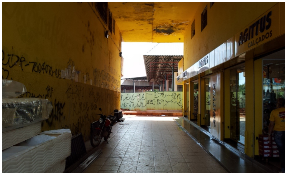
Figura 28: Estado de conservação em edifício particular. Fonte: Acervo pessoal.
