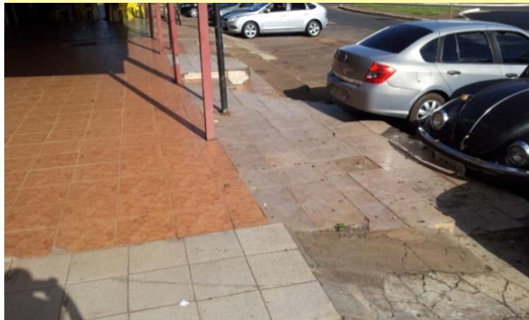
Excesso de desníveis
