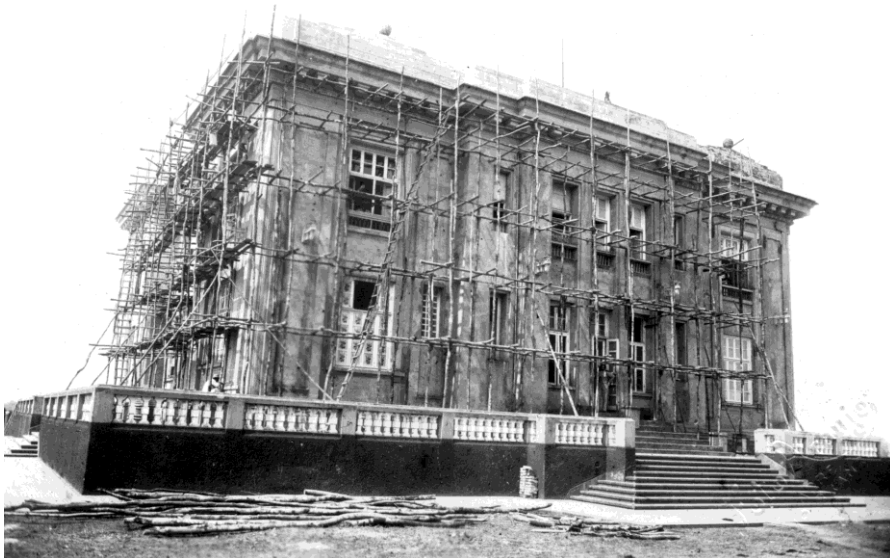
Foto 7 - Palácio Rio Branco Durante obras de reforma no governo de José Guiomard Santos Fonte: Acervo Digital do Departamento de Patrimônio Histórico – FEM
