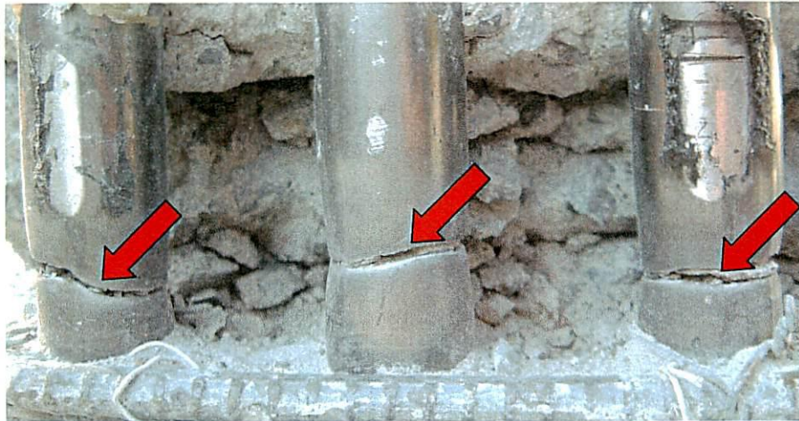
写真 3.3 鋼管の破断 (T27N5M)
