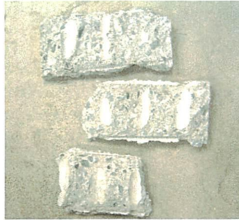
写真 3.17(2) 剥落したコンクリート (T27N10C)
