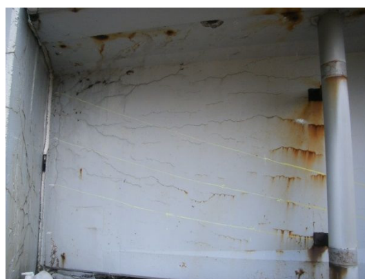
(b) ASR が原因と考えられるひび割れ
