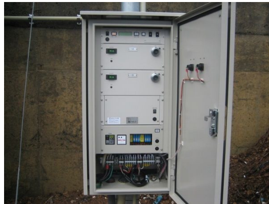
写真 3.3.7 電子メールを利用した遠隔監視装置付き直流電源装置
