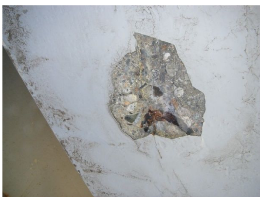
(a) かぶりコンクリートのはく離
