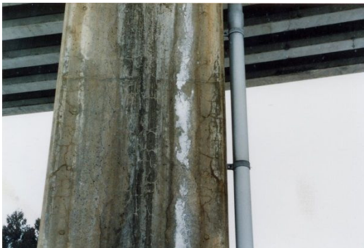
写真 1.4.2 凍結防止剤の影響を受けた ASR 損傷橋脚の劣化状況
