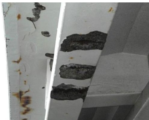
(a) 表面被覆工後の再劣化
