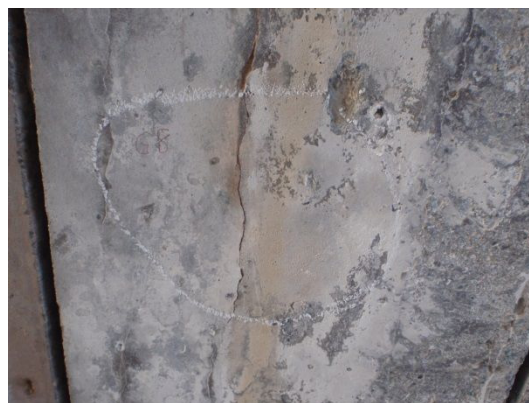
h) K 橋 ホロー桁（橋軸方向のひび割れ）
