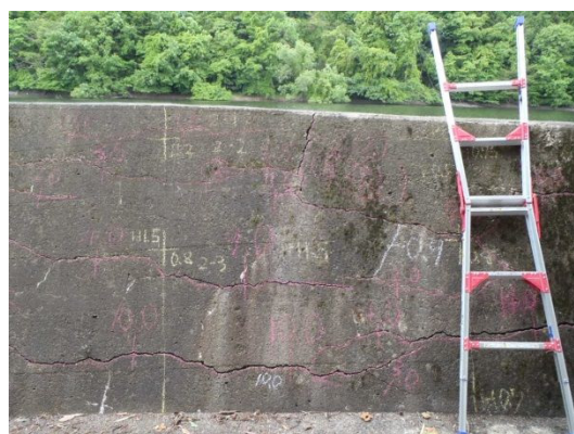
(b) 水平方向のひび割れ（最大幅 10mm）
