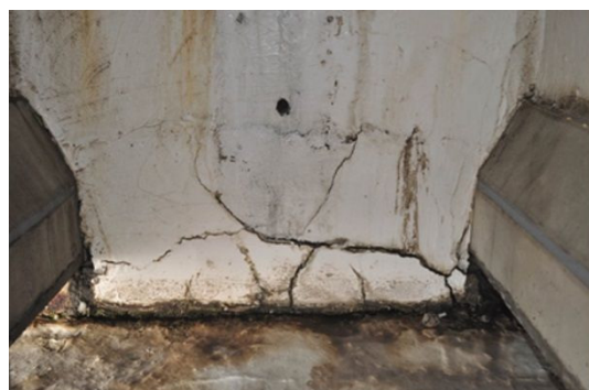
(d) (参考) 端横桁のコンクリートのはく離 (電気防食未施工部)
