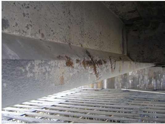
(a) E 橋 主桁 (鋼材腐食・はく離)
