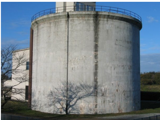
(e) サージタンク
