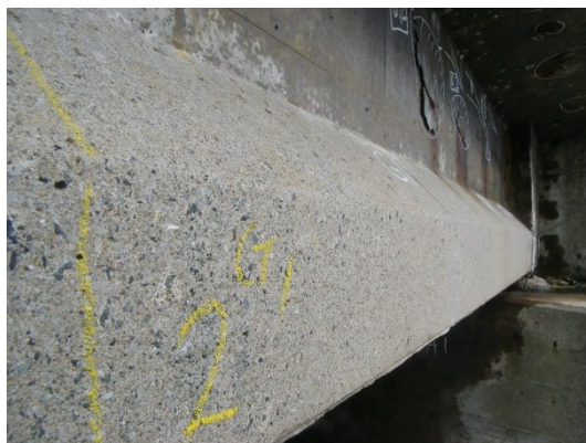
写真 3.2.3 G 橋での飛砂による主桁セメントペースト分の消失状況
