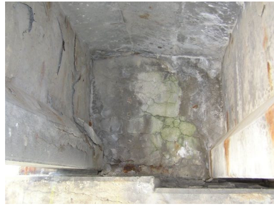
(b) E 橋 端横桁 (亀甲状ひび割れ)
