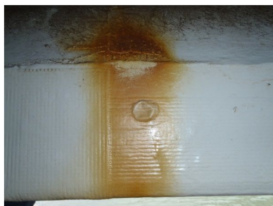
(d) 炭素繊維接着工後の再劣化
