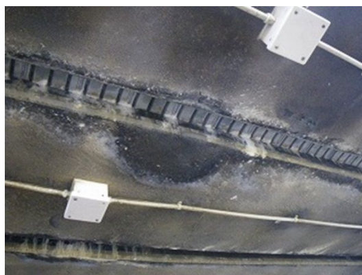
写真 3.2.5 チタン溶射皮膜の劣化状況 20)
