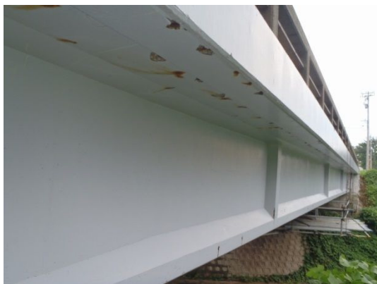
(e) J 橋 張出床版 (定着具の腐食)
