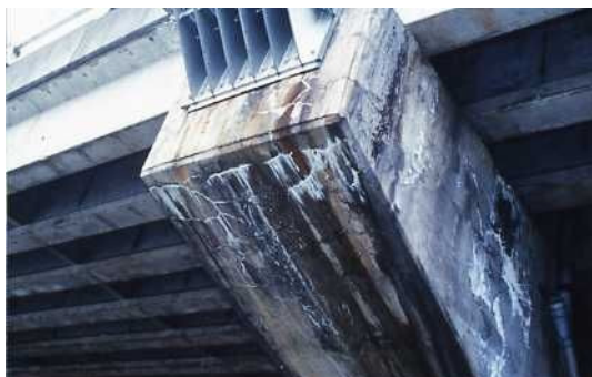
写真 1.4.5 凍結防止剤の影響を受けた 橋脚端部の劣化状況
