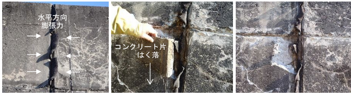
(a) 擁壁鉛直目地材の押出し (b) 水平方向の膨張力によるはく落 (c) コンクリート片のはく落跡
