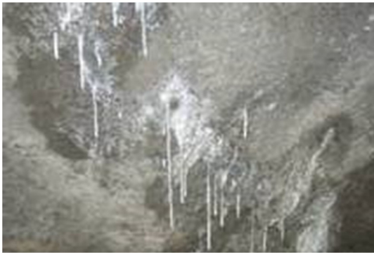
写真 2.3.5 吹付けコンクリートのひび割れから生じた遊離石灰
