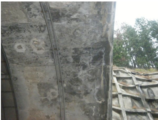
(c) トンネル C 覆工 (旧門前町産-安山岩砕石 A) ASR の判定 : 亀甲状ひび割れ, 白色析出物
