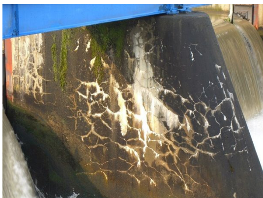
(a) 堰柱の劣化状況（補修前）
