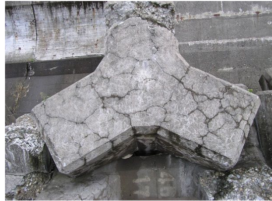
(b) 亀甲状ひび割れ (写真(a)の詳細)
