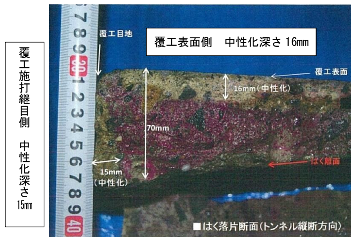
写真 2.4.4 覆工コンクリートはく落片の中性化深さ試験結果
