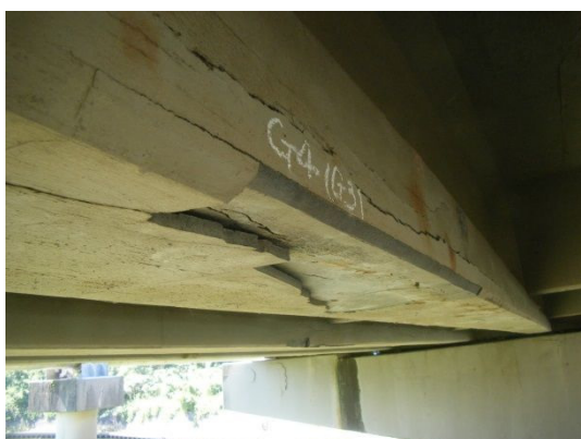
(c) 断面修復工後の再劣化
