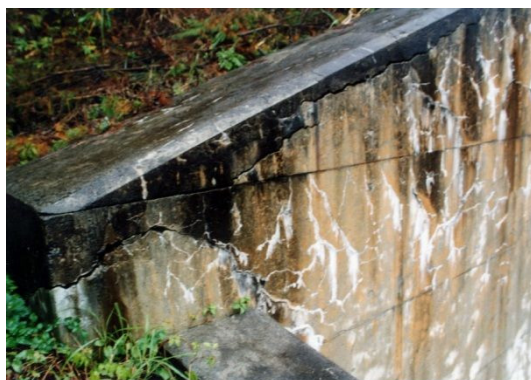
写真 1.4.7 ASR 劣化トンネル坑門のコンクリートの状況
