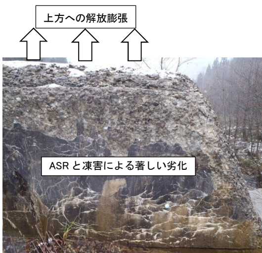
(c) 水通し袖部の ASR と凍害の複合劣化
