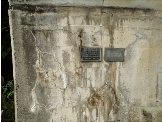
ASR による亀甲状ひび割れ
