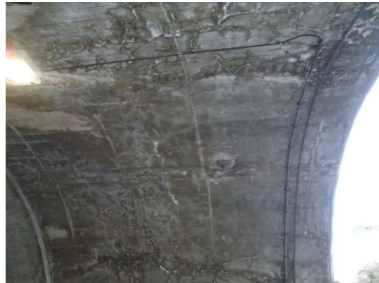
(b) トンネル B 覆工 (手取川産-川砂利 A) ASR の判定 : 亀甲状ひび割れ, 白色析出物
