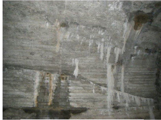
コールドジョイントのひび割れ
