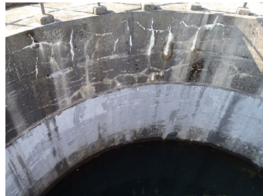
(d) サージタンク内壁での ASR による劣化
