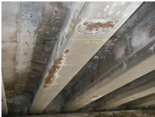
(c) G 橋 主桁 (鋼材腐食・はく離)
