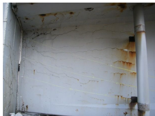
(f) J 橋 主桁端部 (PC 鋼材に沿ったひび割れ)
