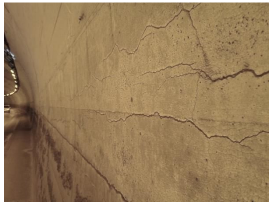
(d) トンネル D 覆工 (輪島市産-安山岩砕石 C) ASR の判定 : 水平方向に延びるひび割れ
