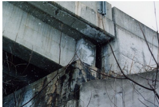
写真 1.4.3 凍結防止剤の影響を受けた ASR 損傷橋台の劣化状況
