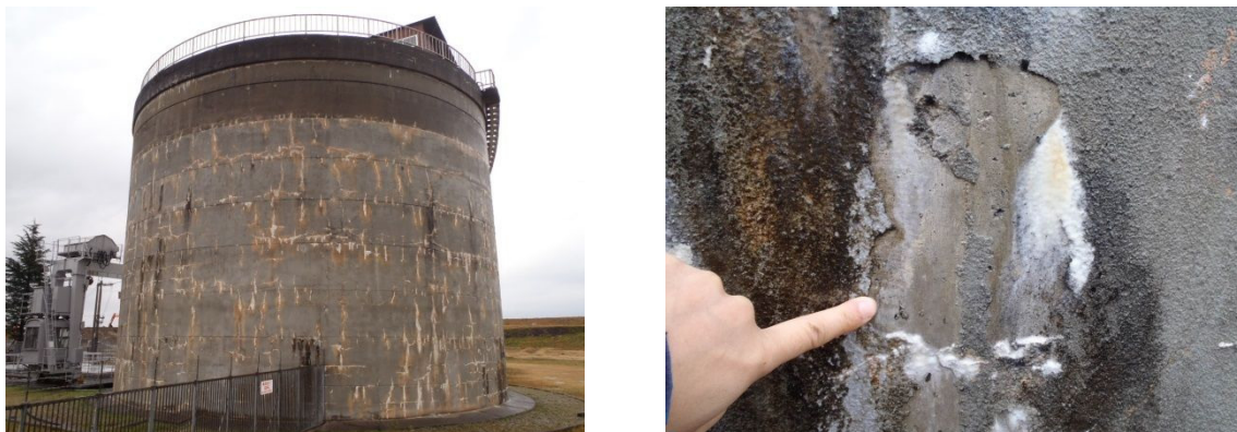
写真 4.4.2 サージタンクにおけるけい酸ナトリウム系補修材料塗布後の再劣化
