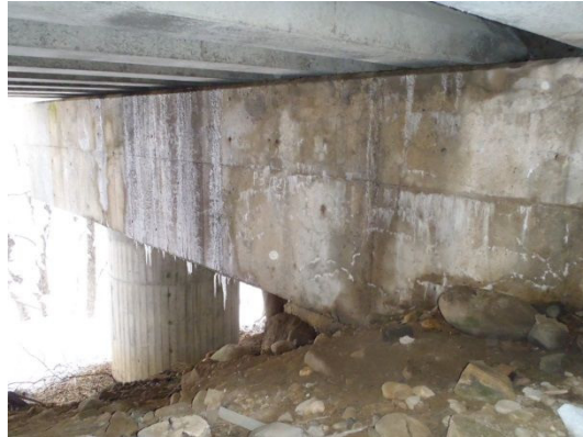
写真 1.4.4 凍害の影響を受けた橋脚の梁の劣化状況
