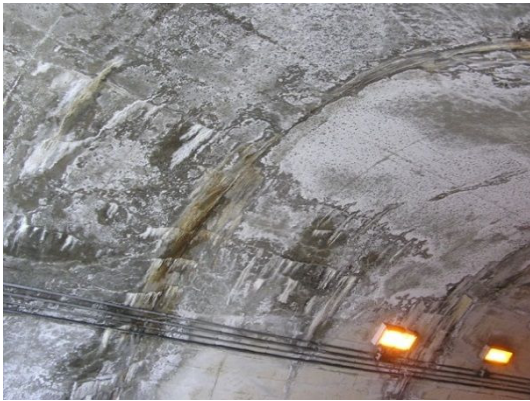
(a) トンネル A 覆工 (旧門前町産-安山岩砕石 A) ASR の判定 : 亀甲状ひび割れ, ゲル滲出による濡れ
