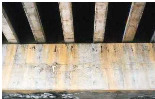
写真 1.4.6 ASR 劣化コンクリート橋脚 におけるかぶりコンクリートのはく落
