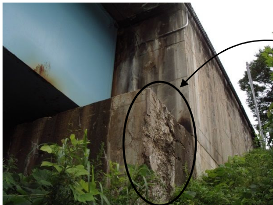
顕著なスケーリングが見られた橋台
