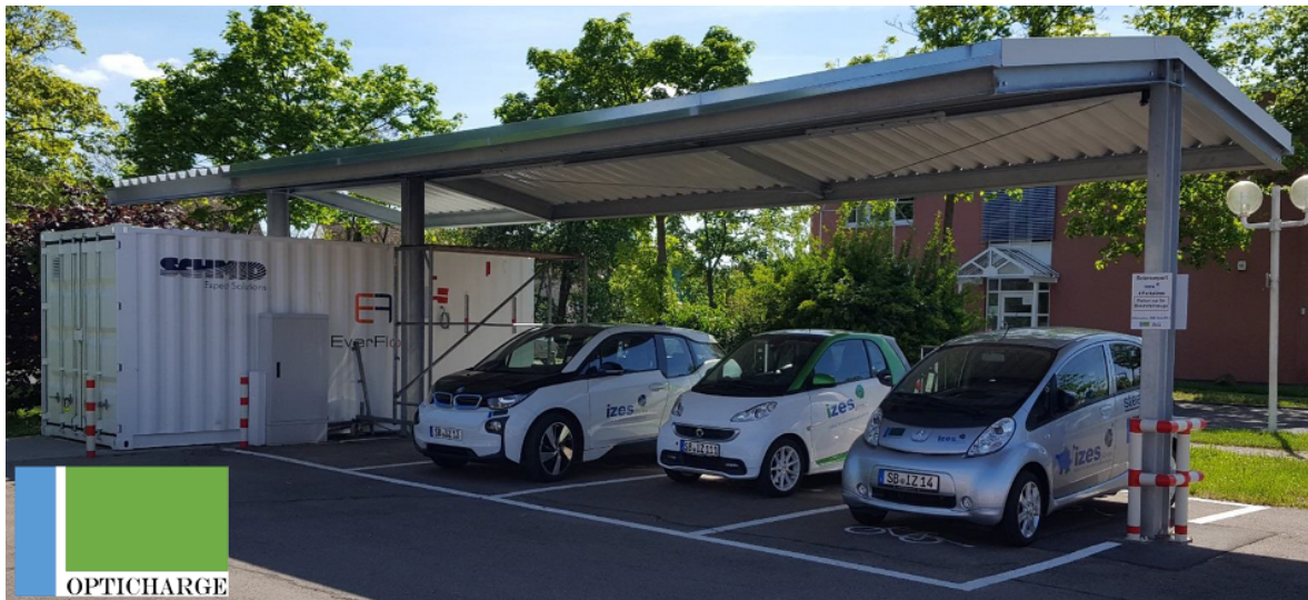
Abbildung 1.3.: Stromtankstelle mit der Photovoltaikanlage auf dem Carportdach, dem VRFB-Container links und den eingesetzten Elektrofahrzeugen.
