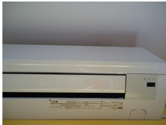
Figura 3-19. Equipo Climatización instalados
