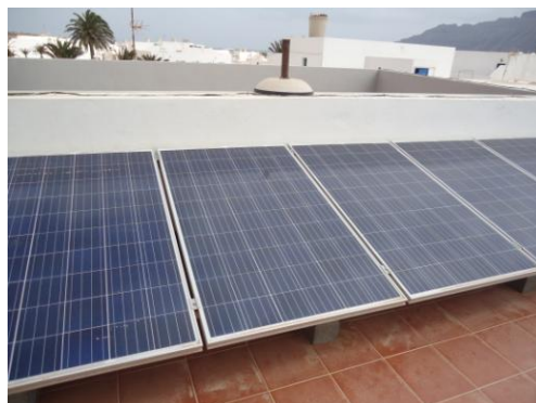
Figura 3-22. Instalación Fotovoltaica viviendas
