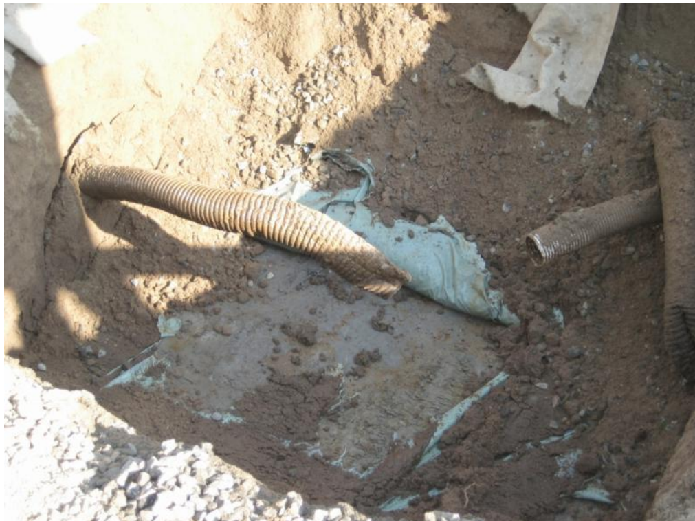
Kuopio 4. Näytteenottokuopan pohja. Näkyvissä suodatinhiekkää, katkennut kokoo-putki ja kaivaessa revennyt pohjan muovieriste.
