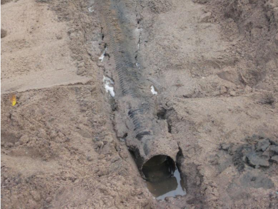
Kuva 31. Raaseporin maasuodattimen tuuletusputki Fosfilt-hiekka-kerroksen yläpinnalla.
