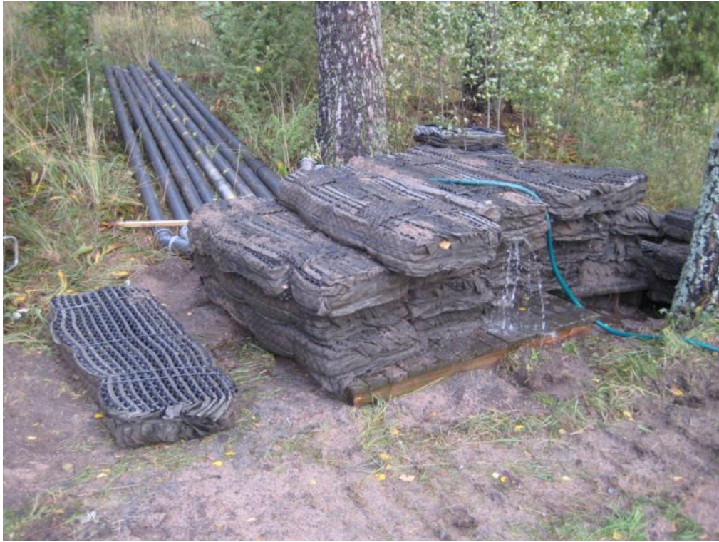
Raasepori 1. Maasuodattamossa käytetyt In-Drän modulit pesua varten kasattuina. Moduulit käytettiin pesun jälkeen uudelleen saneeratussa puhdistamossa.
