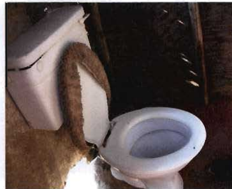
Plate 8: Pour flush toilet to septic tank
