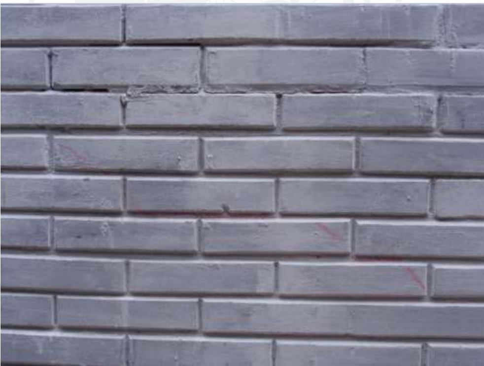
Fig.8.5 Grietas diagonales en las unidades.
