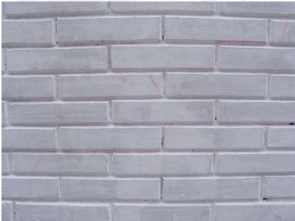
Fig.8.4 Grietas en la unión ladrillo con mortero.
