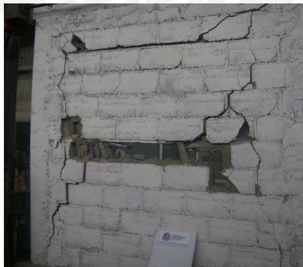
Fig. 5-40. Grietas a lo largo de la longitud de la columna.
