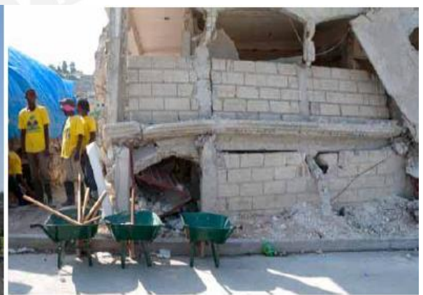
Fig 1-2. Falta de confinamiento
