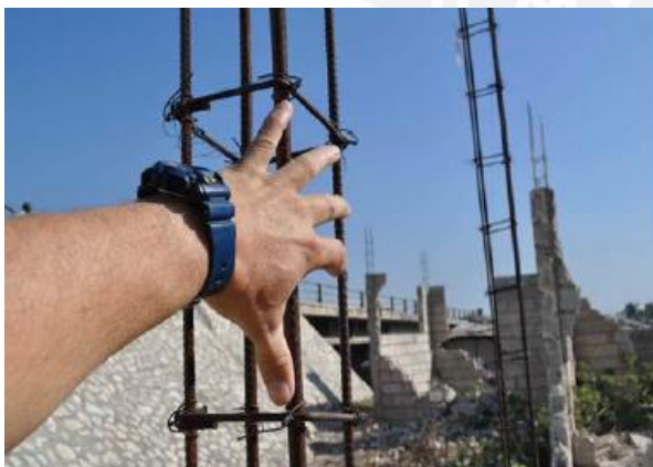
Fig 1-1. Estribos con gran espaciamiento
