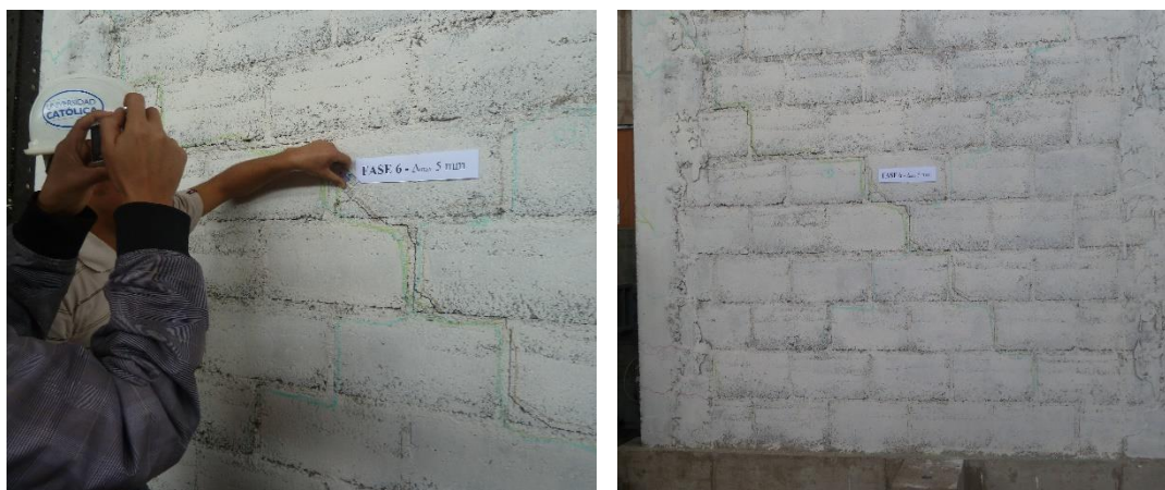
Fig. 5-30. Fase 6: Ancho de fisuras de 0.40mm.
