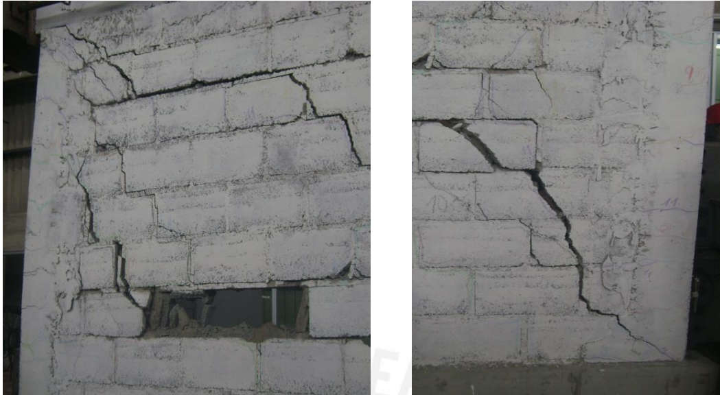
Fig. 5-39. Grietas a lo largo de la longitud de la columna.
