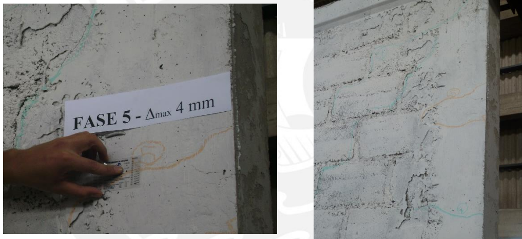
Fig. 5-29. Fase 5: Grietas en la parte superior de las columnas.
