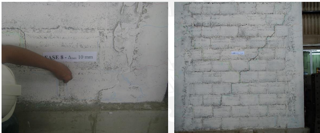
Fig. 5-32. Fase 8: Aparición de fisuras en la parte inferior del muro.
