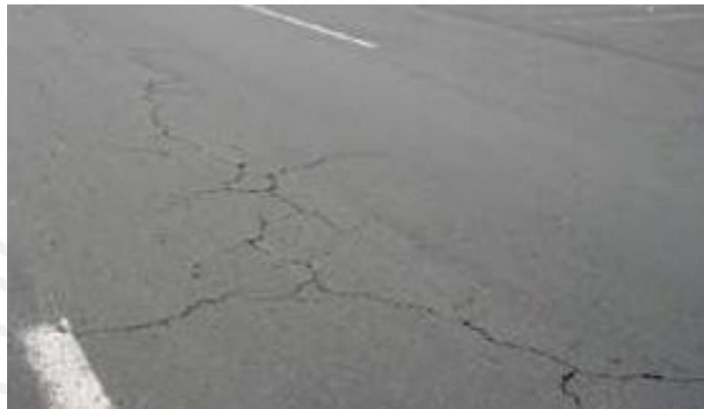
Figura 4. Agrietamiento longitudinal y transversal.
