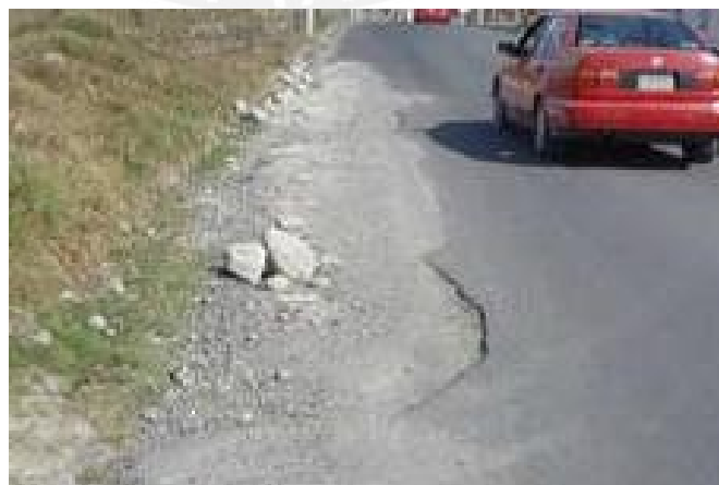
Figura 3. Agrietamiento de borde.
