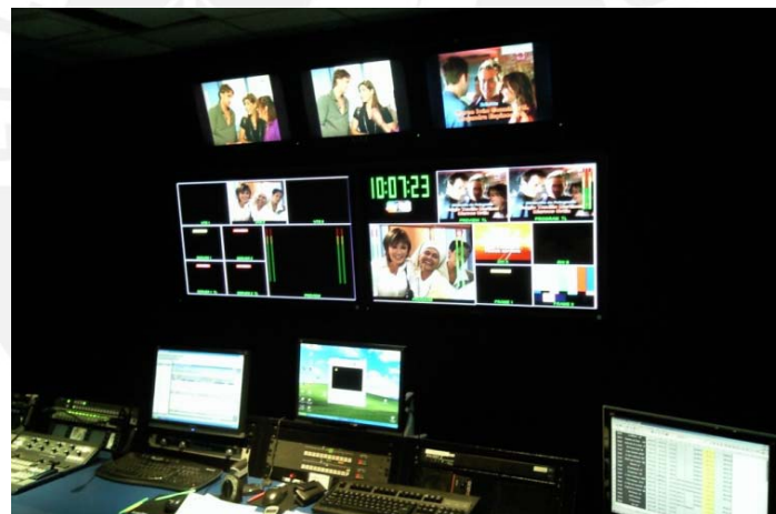
Figura 2.6 – Sala de Control Maestro Instalaciones de ATV, Andina de Radiodifusión.
