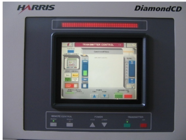
Figura 2.12 – Interface Transmisor DiamondCD™ Instalaciones de ATV, Andina de Radiodifusión.
