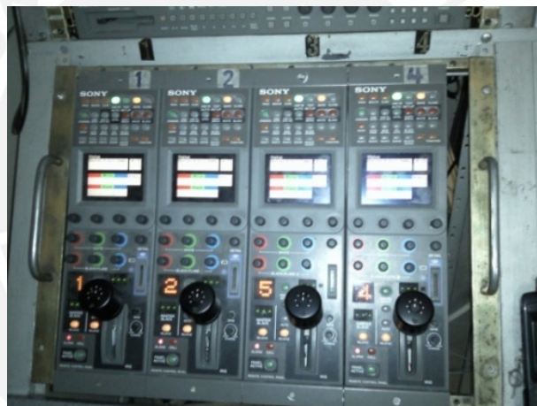
Figura 2.2 – Rack de Camera Control Units (Sony) Instalaciones de ATV, Andina de Radiodifusión.
