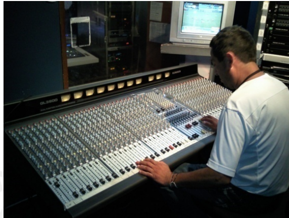
Figura 2.7 – Mezcladora Digital y Control Maestro de Audio Instalaciones de ATV, Andina de Radiodifusión
