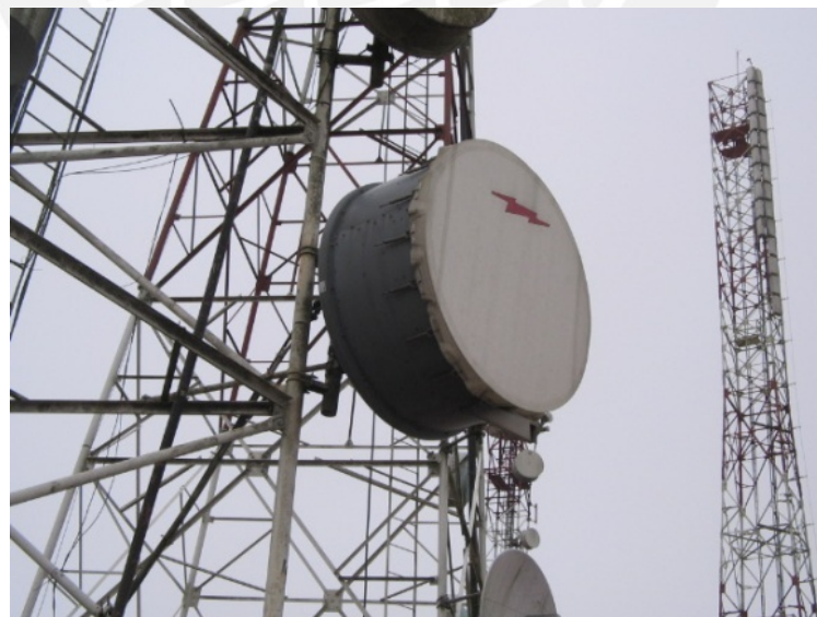
Figura 3.3 – Antena Andrew HP6-130-C3A ubicada en Planta Instalaciones de ATV, Andina de Radiodifusión
