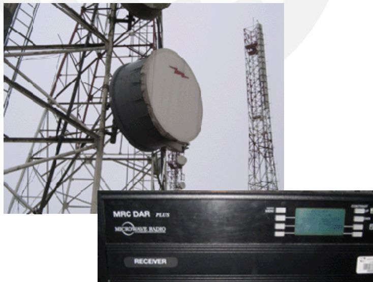
Figura 2.10 – Sistema de Microondas DAR PLUS con antenas de 1.8m Instalaciones de ATV, Andina de Radiodifusión.
