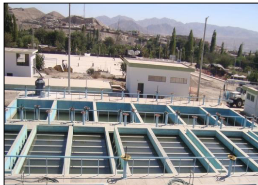
Figura 3.5 Zona de decantación
