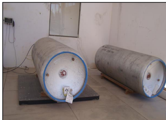
Figura 3.7 Sala de cloración
