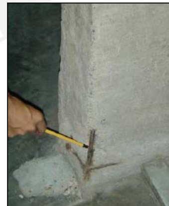
Fig. 8.26 Acero corroído de columna (Flores 2002)
