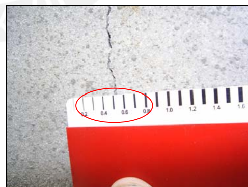
Fig. 8.06 Espesor de la grieta
