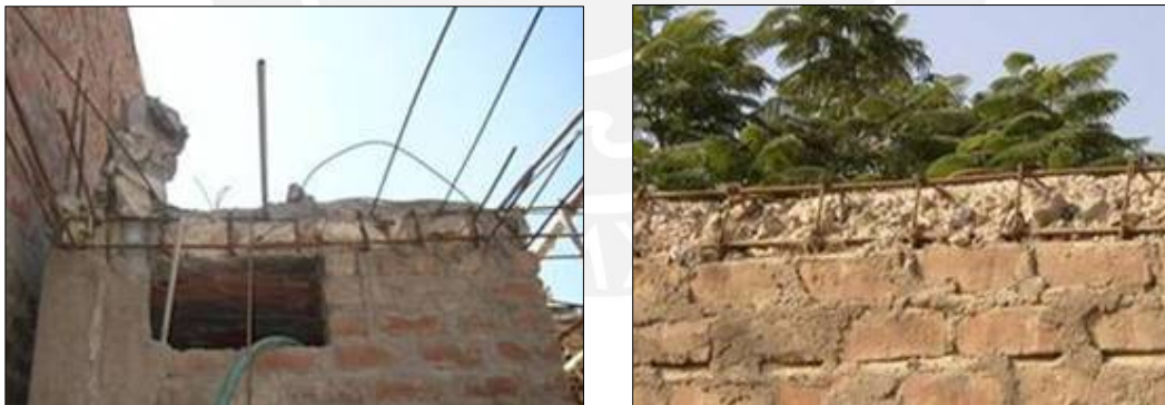
Fig. 5.17 Junta de construcción mal ubicada en vigas
