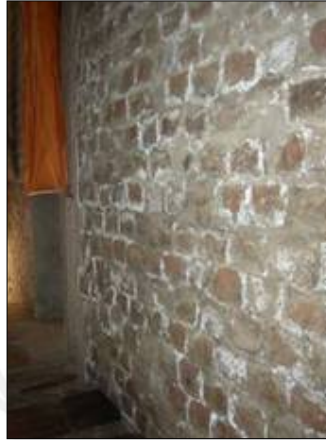
Fig. 5.21 Muro con eflorescencia
