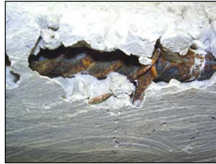
Fig. 8.28 Acero de refuerzo corroído
