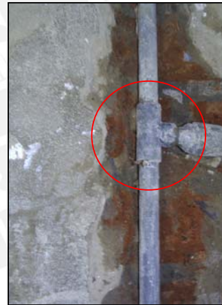
Fig. 8.41 Fuga de agua en la unión de tuberías
