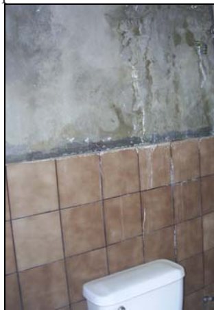
Fig. 8.38 Humedad en muro de baño
