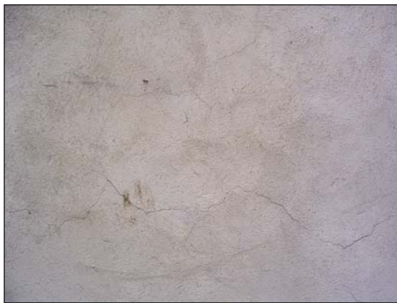
Grieta en tarrajeo
