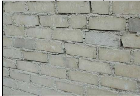
Fig. 8.14 Grieta de espesor mayor 1.5 mm. (Flores 2002)
