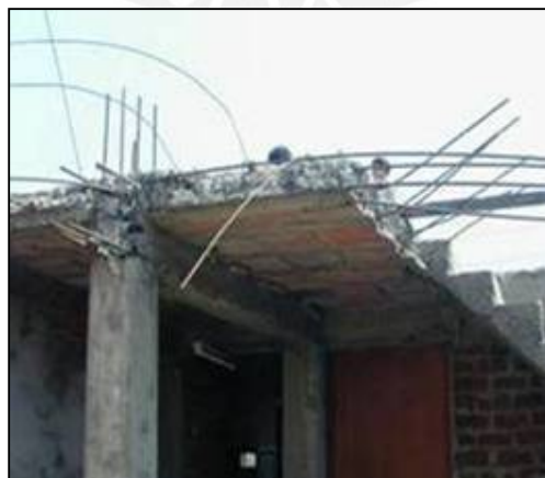
Fig. 5.15 Acero de refuerzo expuesto
