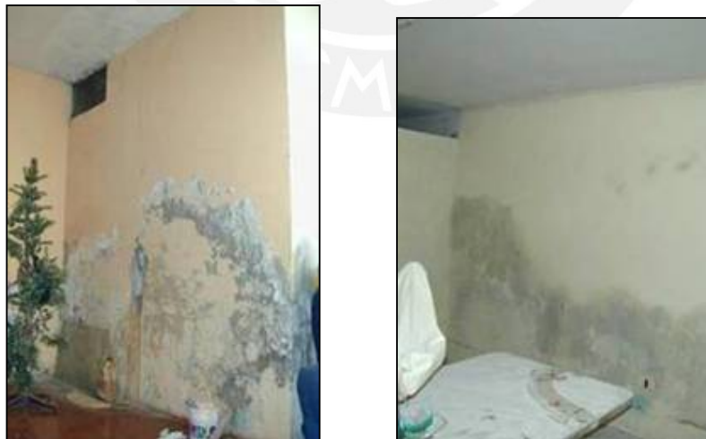
Fig. 5.22 Muros con presencia de humedad
