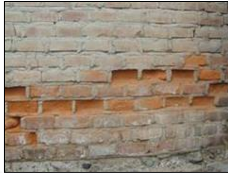
Fig. 5.23 Baja calidad de ladrillo
