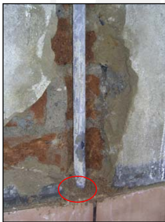
Fig. 8.40 Fuga de agua en tubería rota
