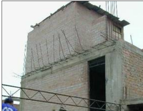
Fig. 5.10 Muros sin confinar
