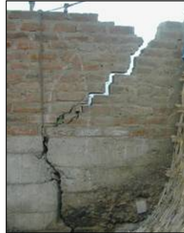
Fig. 5.02 Muro agrietado por asentamientos diferenciales
