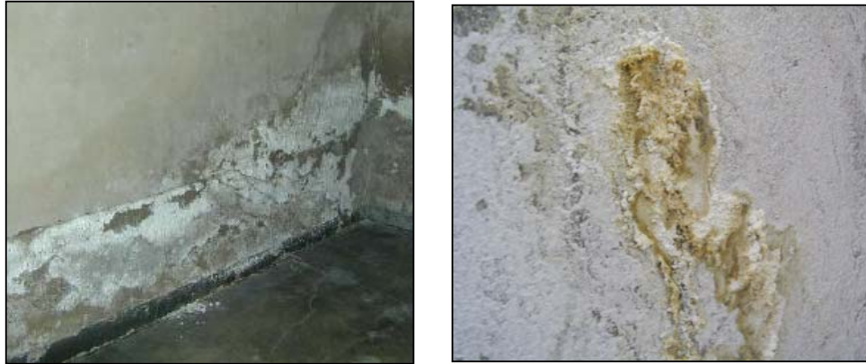
Fig. 8.34 Eflorescencia en muro
