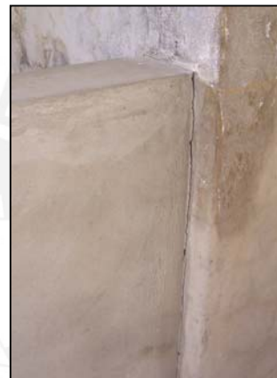
Grieta en unión tabique muro
