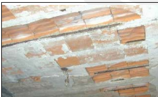
Fig. 8.25 Acero corroído de aligerado (Flores 2002)
