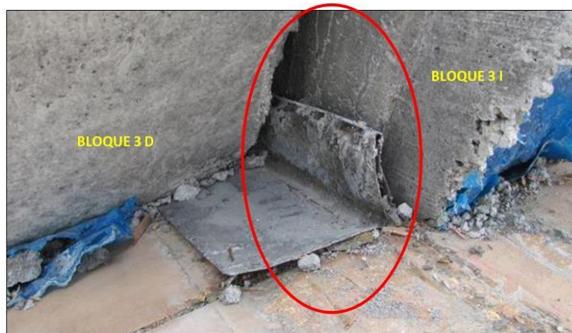
Figura 22. Deslizamiento de bloques de concreto – Primera prueba
