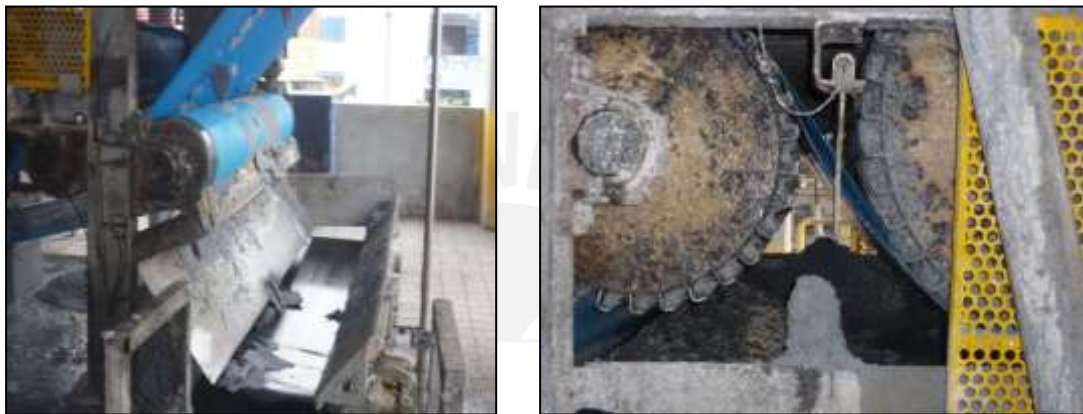
Figura 1.9 Deshidratación de los lodos a través de fajas [Kimberly: 2013]
