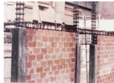
Detalle constructivo del dintel entre muros de albañilería. Tomado del Blog del Ing. San Bartolomé
