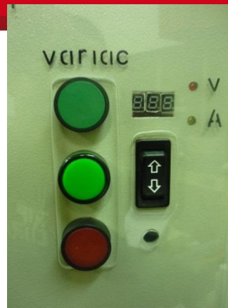
Figura 3.17. Espacio del tablero de control destinado para el control del variac.
