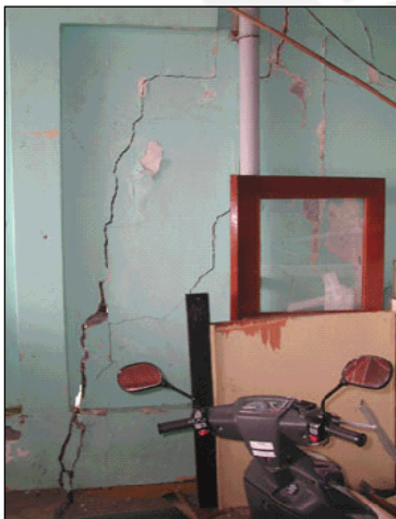
Figura 8.4 (a) Pared colapsada debido a asentamiento del terreno, Sismo Damas – Costa Rica 2004. ( www.fing.ucr.ac.cr )
