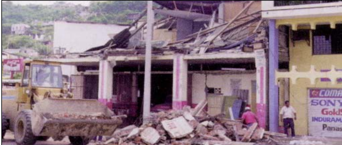
Figura 10.1.2 (a) Terremoto de Bahía de Caráquez 1998 - Estación de bomberos, colapso del segundo piso de albañilería de ladrillo sin reforzar y techo liviano. (Fernández, 1998)
