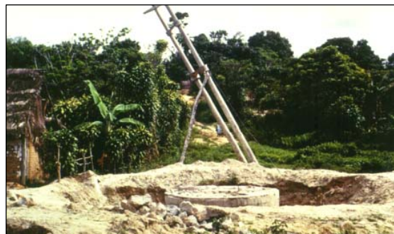
Figura 8.2 (i) Daño estación de bombeo y subestación eléctrica debido a licuación del suelo – Terremoto 1991. CISMID
