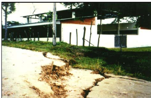
Figura 8.2 (h) Agrietamiento del terreno en Carretera Moyabamba – Puerto Tahuisco. Terremoto 1990. CISMID
