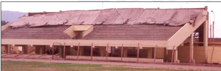
Figura 9.1.3 (f) Influencia del sismo vertical: colapso del techo voladizo del Estadio Municipal de Nazca, Quiun 1997.
