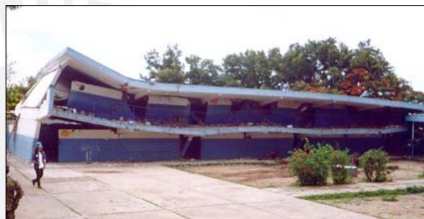
Figura 7.1.2 (p) Falla debido a estructura de pórticos muy flexibles. Escuela Valentín Valiente. ( http://midas.upr.clu.edu )
