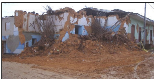
Figura 7.2.2 (e) Terremoto de San Martín 2005, falla típica de esquina en vivienda de adobe, Lamas.
