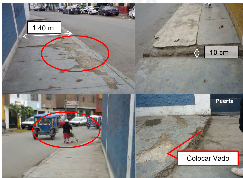
Figura 62 Deficiencias encontradas en las veredas. Referencia: alrededor del Colegio San Pedro. Fuente: Elaboración propia.
