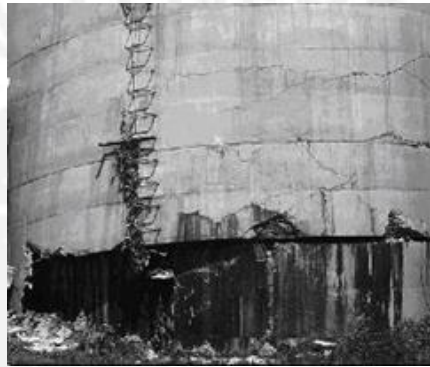
Figura 1.1 Desplazamiento en la base de un tanque.
