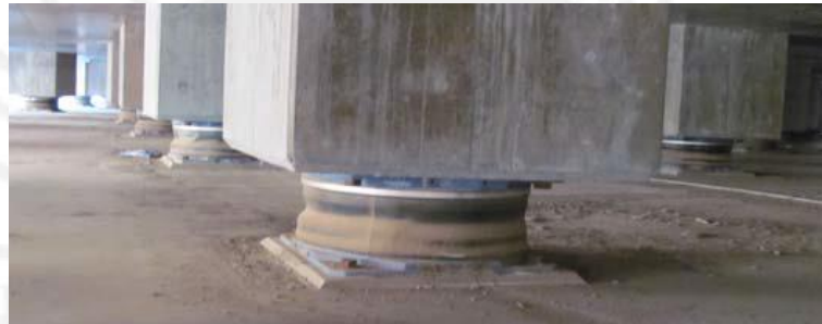
Figura 1.7 Aisladores instalados en la cimentación de un tanque para almacenamiento de gas natural líquido.
