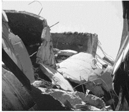
Figura 1.3 Colapso de un tanque.
