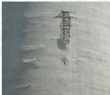
Figura 1.2 Pandeo de las paredes de un tanque.
