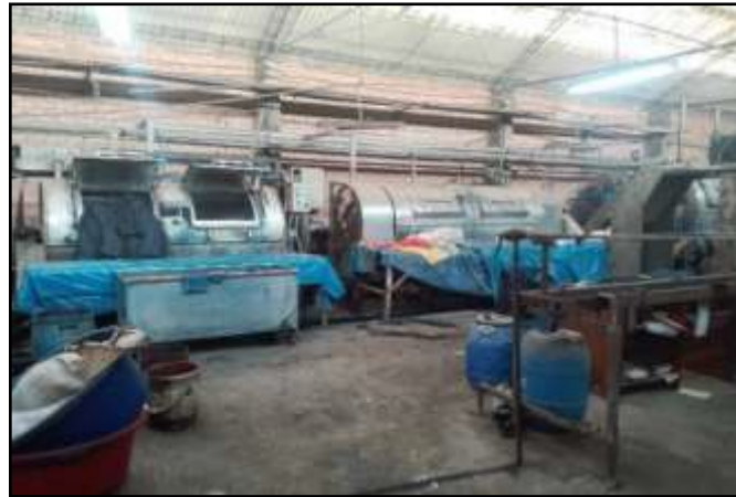
Figura 13: Lavadoras frontales industriales Fuente: La empresa
