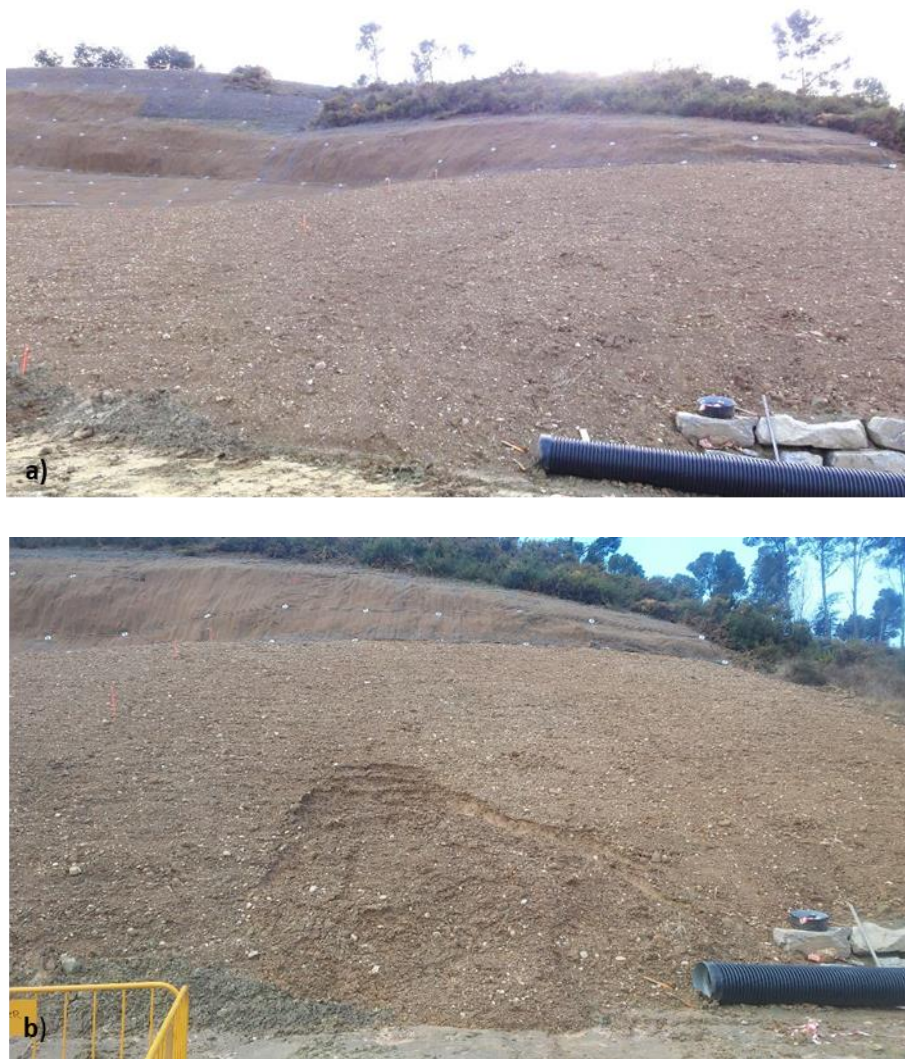
Figura 23. Fotografies de la zona control C1 el dies 2 (a) i el 8 (b) de febrer de 2018. A la imatge inferior s'identifica l'esllavissada induïda per les pluges succeïdes entre els dies 4 i 6 de febrer de 2018.
