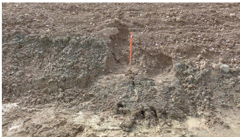
Figura 24. Detall de l'esllavissada succeïda a la part inferior del límit entre C1 i E1.
