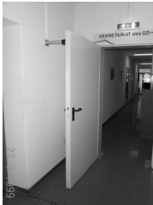
Automatisch schließende Brandschutztüren sorgen für Sicherheit im Brandfall
