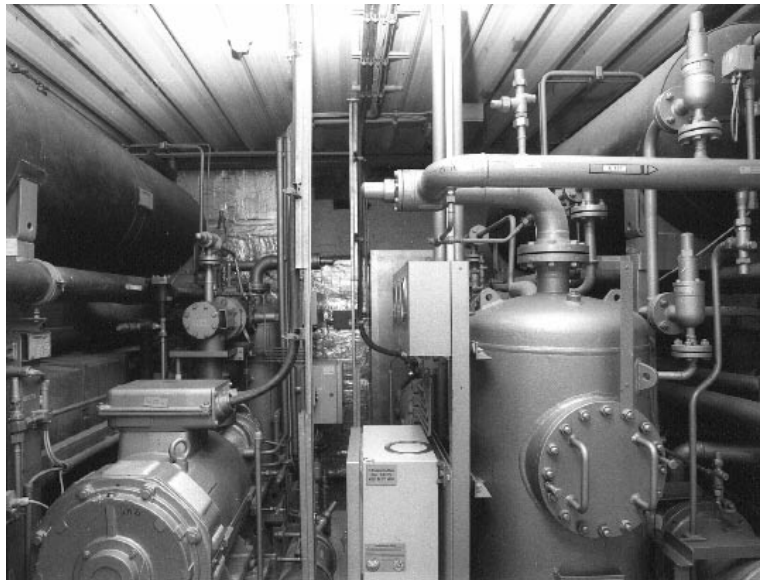
Die neu installierte Kühlanlage auf dem Dach des Telefunken-Hochhauses wird mit dem ozonschicht- und klimaneutralen Kühlmittel Ammoniak betrieben
