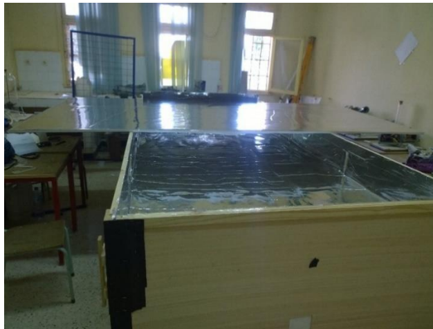
Figure 6.15 : Le revêtement de la face intérieure du plafond en aluminium (Source : Auteur)
