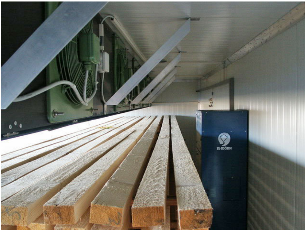
Abbildung 6 Trockenkammer mit Wärmepumpe
