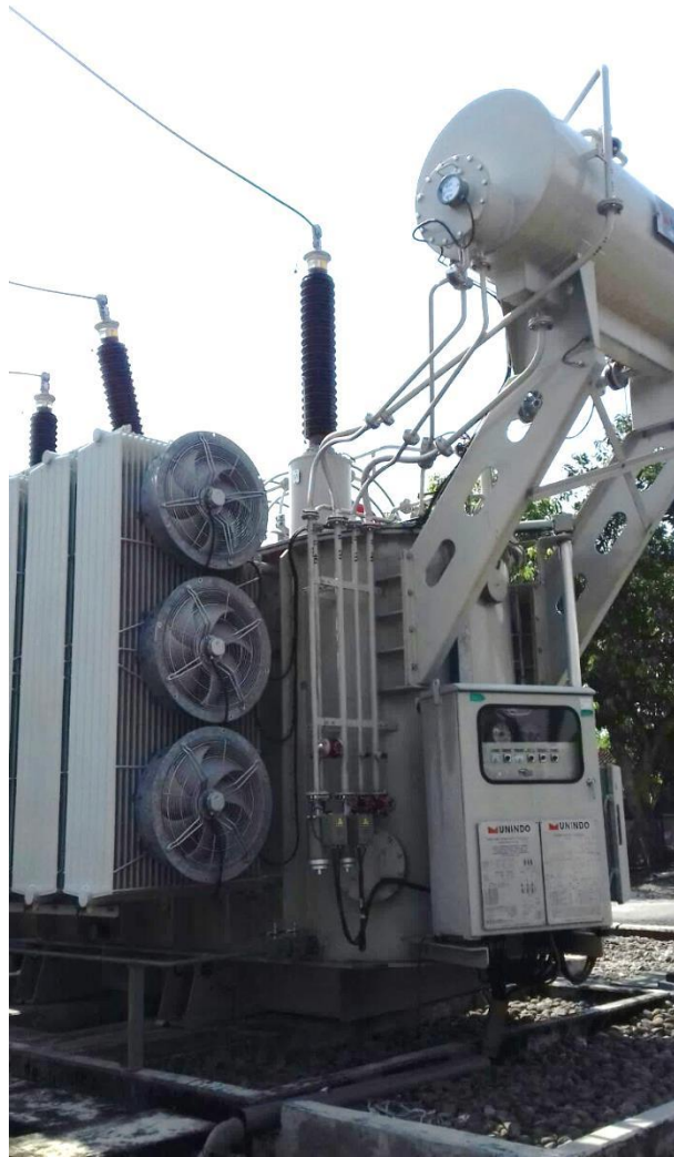
Gambar 3. Transformator Daya pada GI Konvensional
