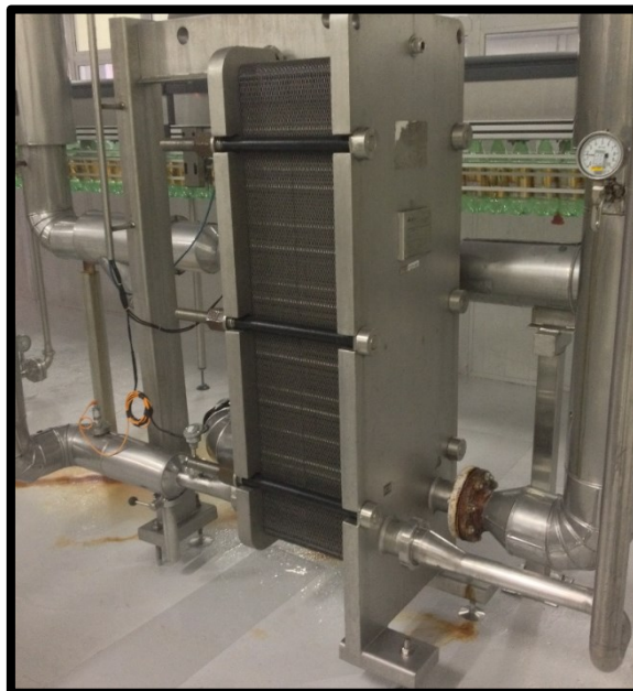
Figura 9 - Trocador de calor na sala de envase
