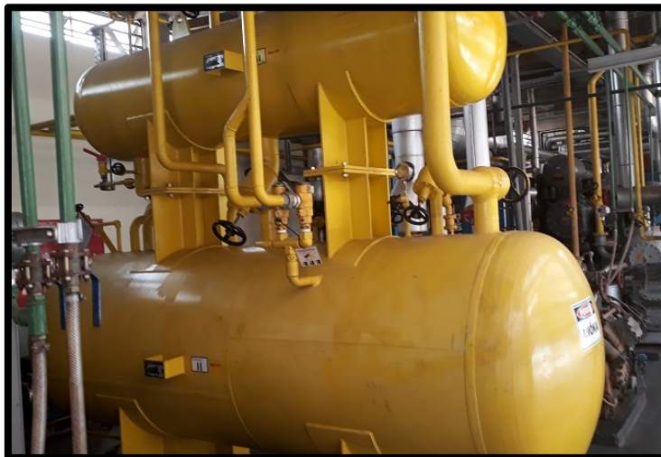
Figura 11 - Reservatório de Amônia
