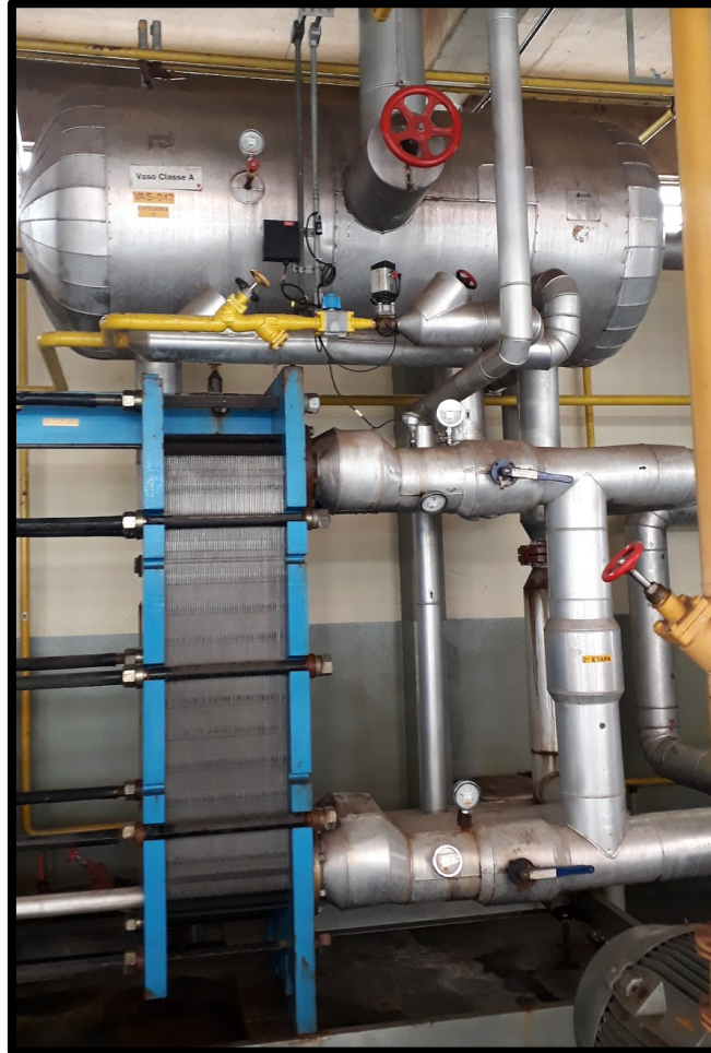
Figura 16 - Separador de líquido horizontal e trocador a placas dos fluidos
