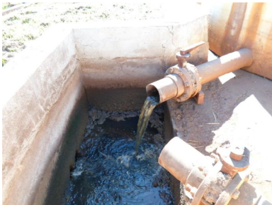
Figura 10- Local de despejo do chorume no interior do aterro sanitário.
