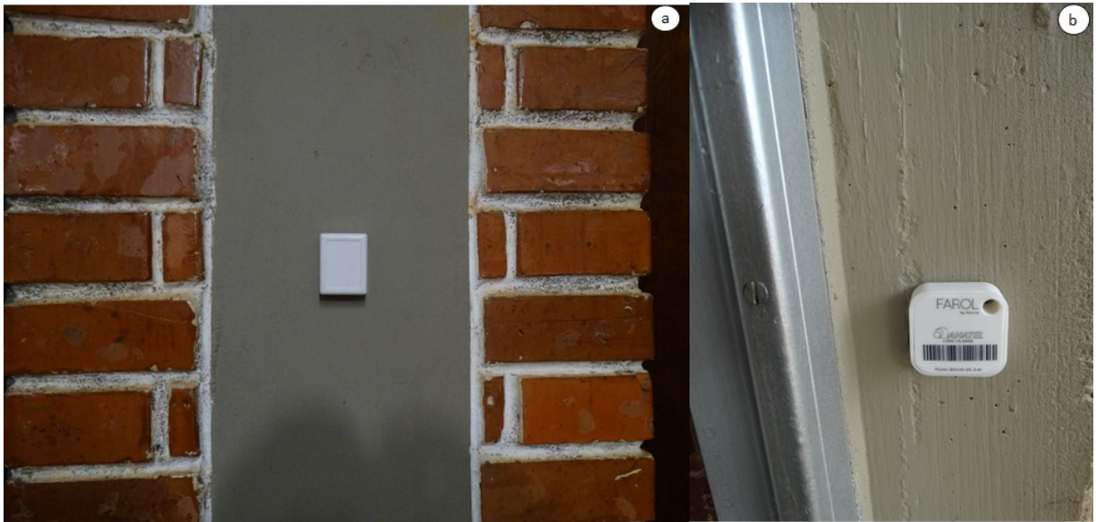
Figura 59. Beacons no ambiente interno do Bloco 1E
