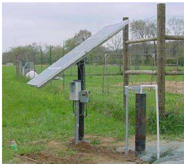
Figura 3 – Sistema de bombeamento fotovoltaico
