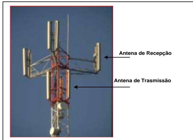
Figura 1.95 - Antenas RX e TX
